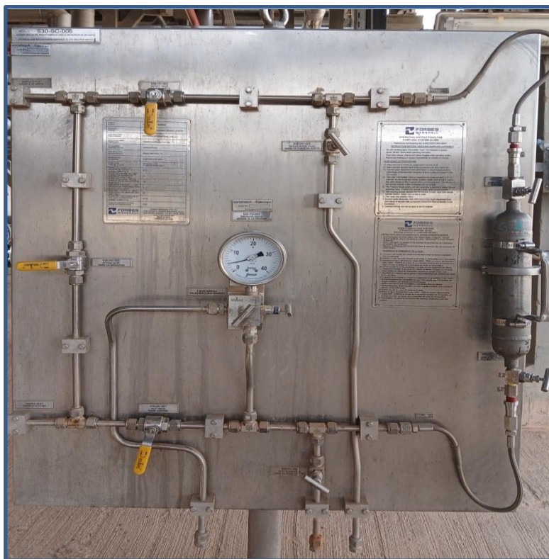
Figure III.21: Canalisation pour le transfert de l'échantillon
