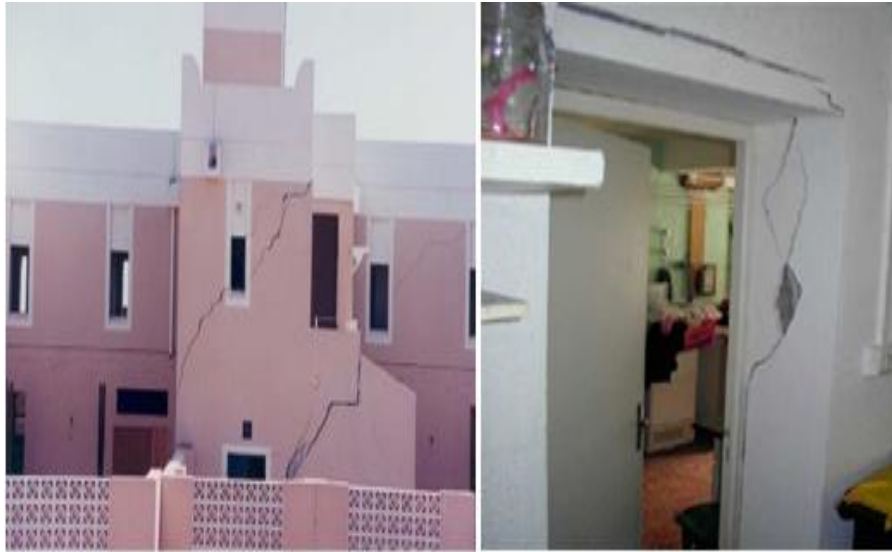
Figure 1.11 : les fissurations d'une maison causé par le gonflant, (AMER ALI et al, 2006).
