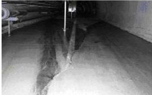
Figure 1. 13: Soulèvement puis dislocation du radier d'un tunnel, (WAKIM, 2005).
