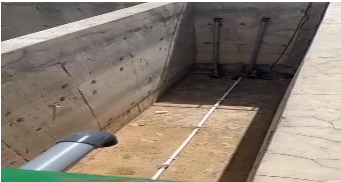
Figure IV.6: bassin de stabilisation des boues
