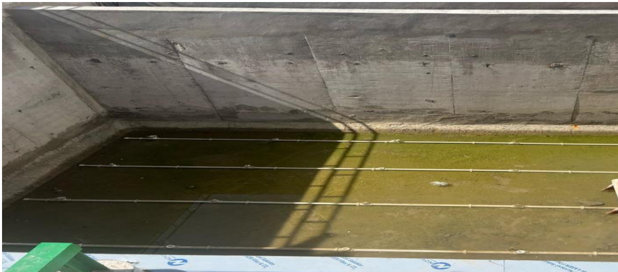
Figure IV.5: photo réelle de bassin d'homogénéisation
