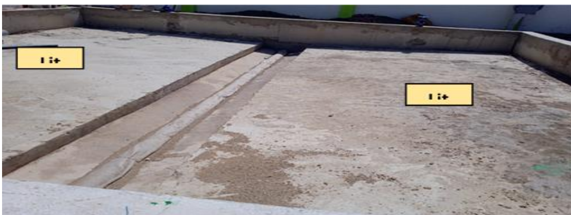
Figure IV.8 : bassin du lit de séchage
