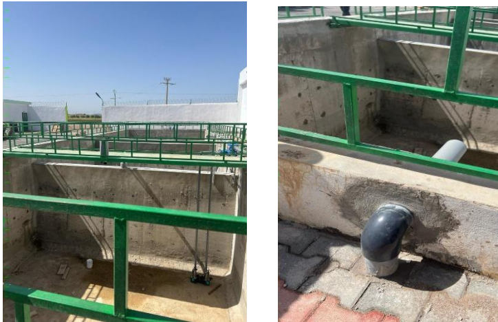
Figure IV.4: photo réel de décanteur primaire
