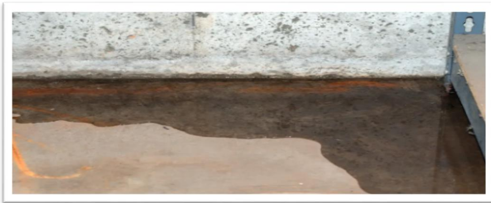
Figure3.7 : infiltration dans le sol.
