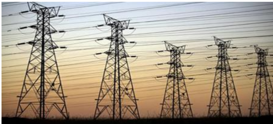
Figure I .5: Supports des lignes aériennes HT (pylône électrique) [16].
