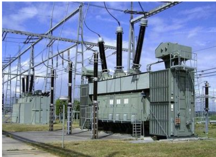
Figure I.8 : Transformateur de puissance dans un réseau électrique [16].
