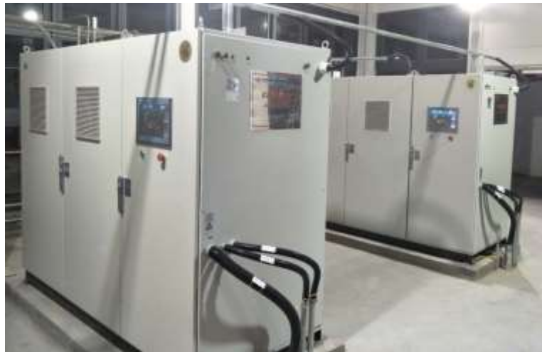
Figure (I.8) : Electrolyseur PME[10]
