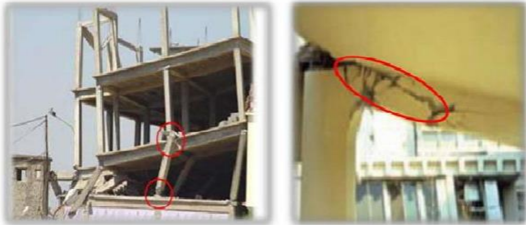
Figure 2.10 : Rotule plastique au niveau des poteaux et des poutres. [15]
