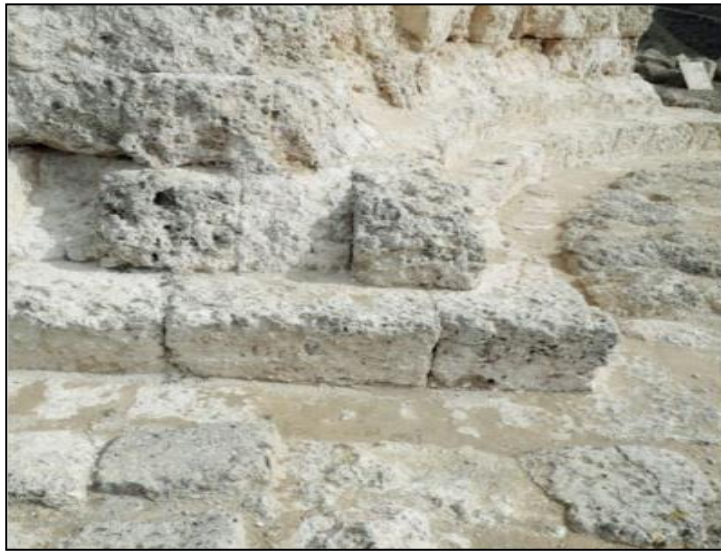
Photographie 52: Dégradation de la pierre des sites archéologiques.
