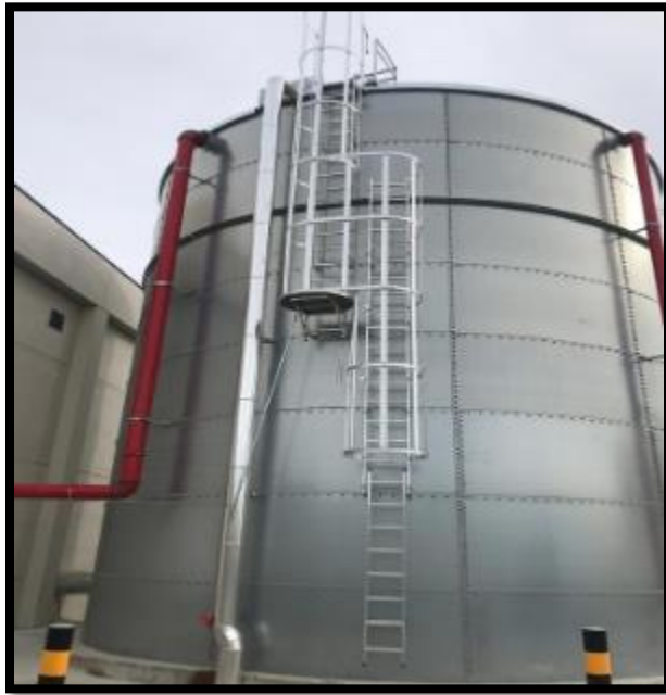
Figure 35 : réservoir de lutte [71]
