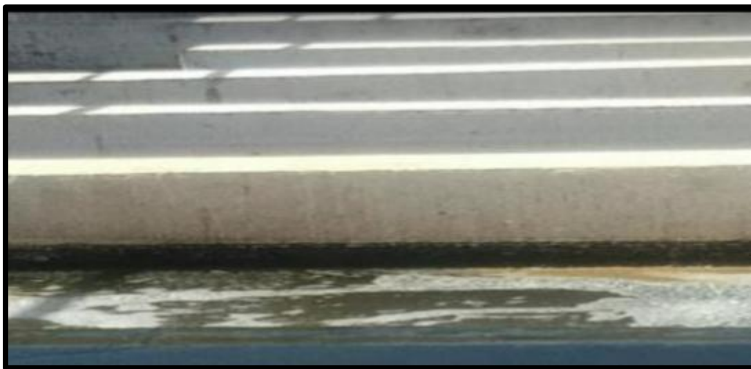
Figure 47 : Le bassin de désinfection [83]
