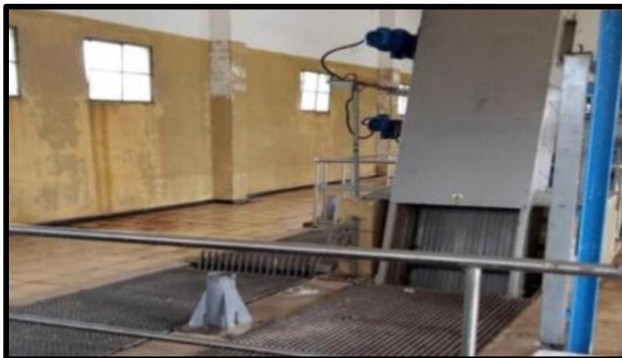
Figure 42 : Grille mécanisée grossière [83]
