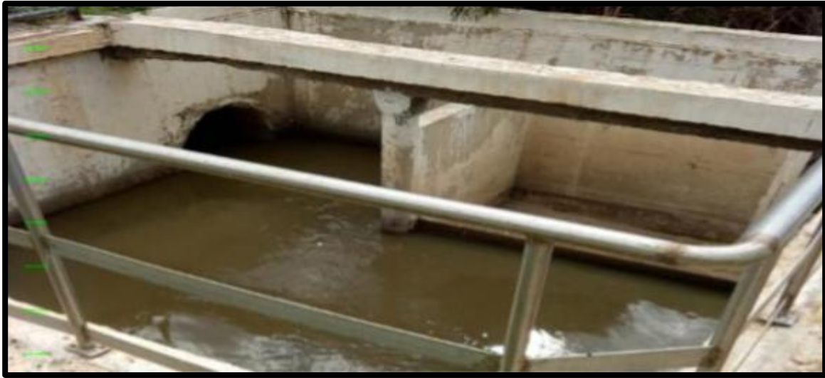
Figure 41 : Le déversoir d'orage [83]
