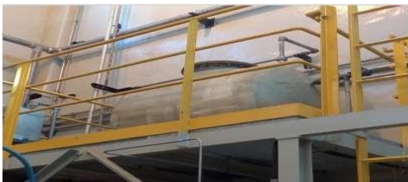
Figure(III.14):La bâche de l'eau déminéralisée
