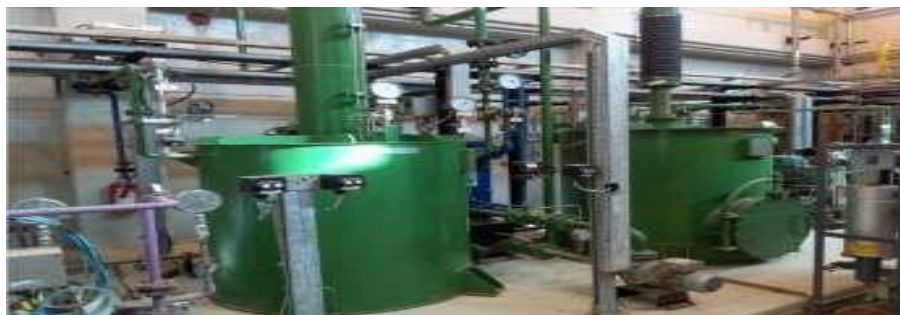
Figure (III.15) :dispositif de lavage de refroidissement
