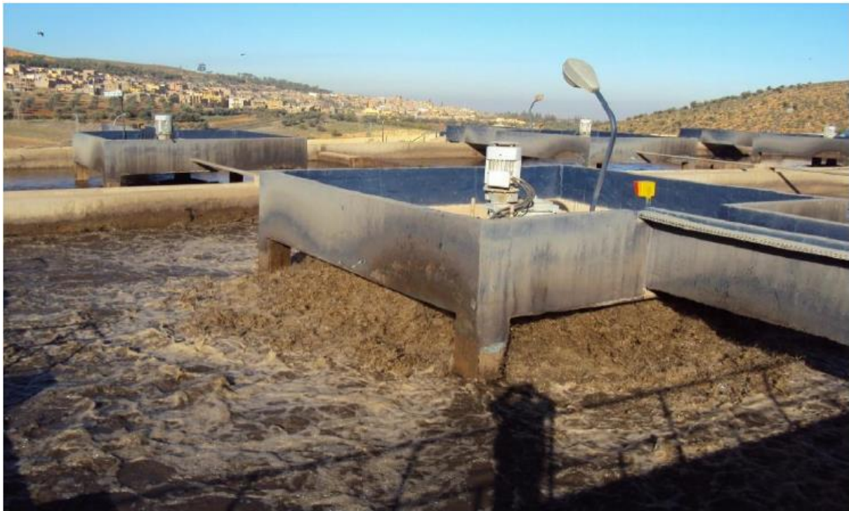
Fig. III-6 photo des bassins d'aérations [54].
