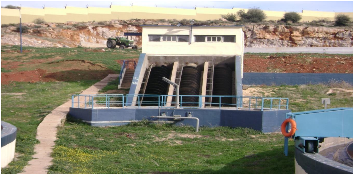
Fig. III.10 photo de la vis de recirculation [54].
