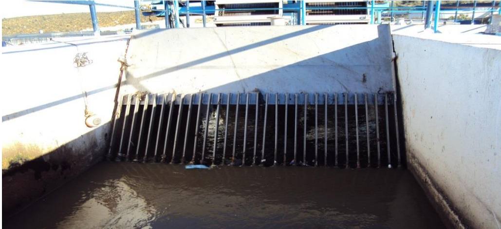
Fig. III-3 photo de la grille grossière manuelle [54].
