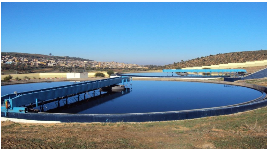
Fig. III-8 photo des clarificateurs [54].
