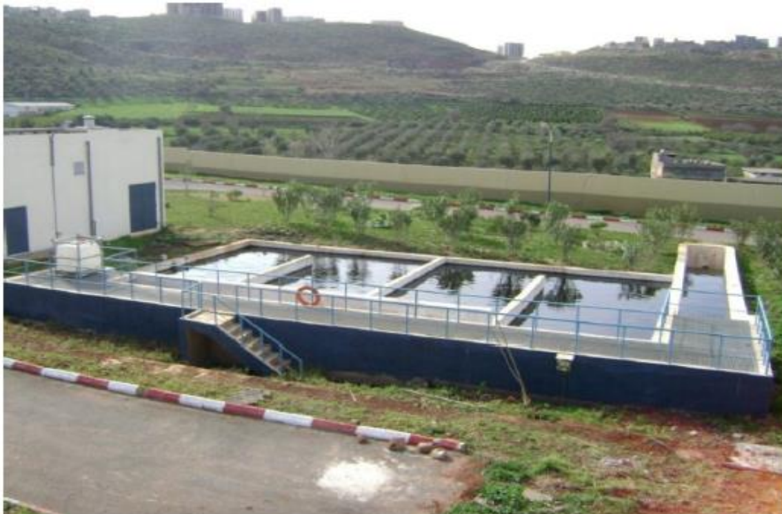
Fig. III-9 photo du bassin de chloration [54].
