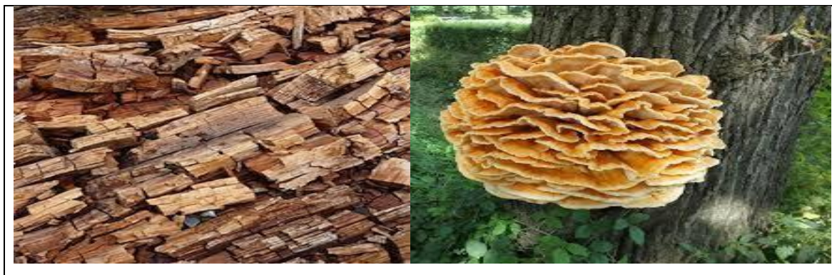
Figure 16 : dégradation du bois Pourriture cubique brune ( laetiporus sulphureus )
