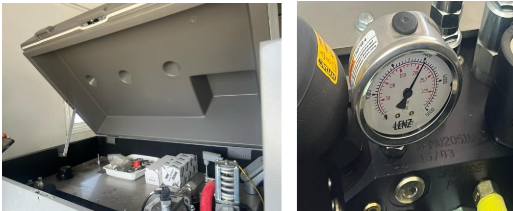
Figure 40 vue interieure du HPU
