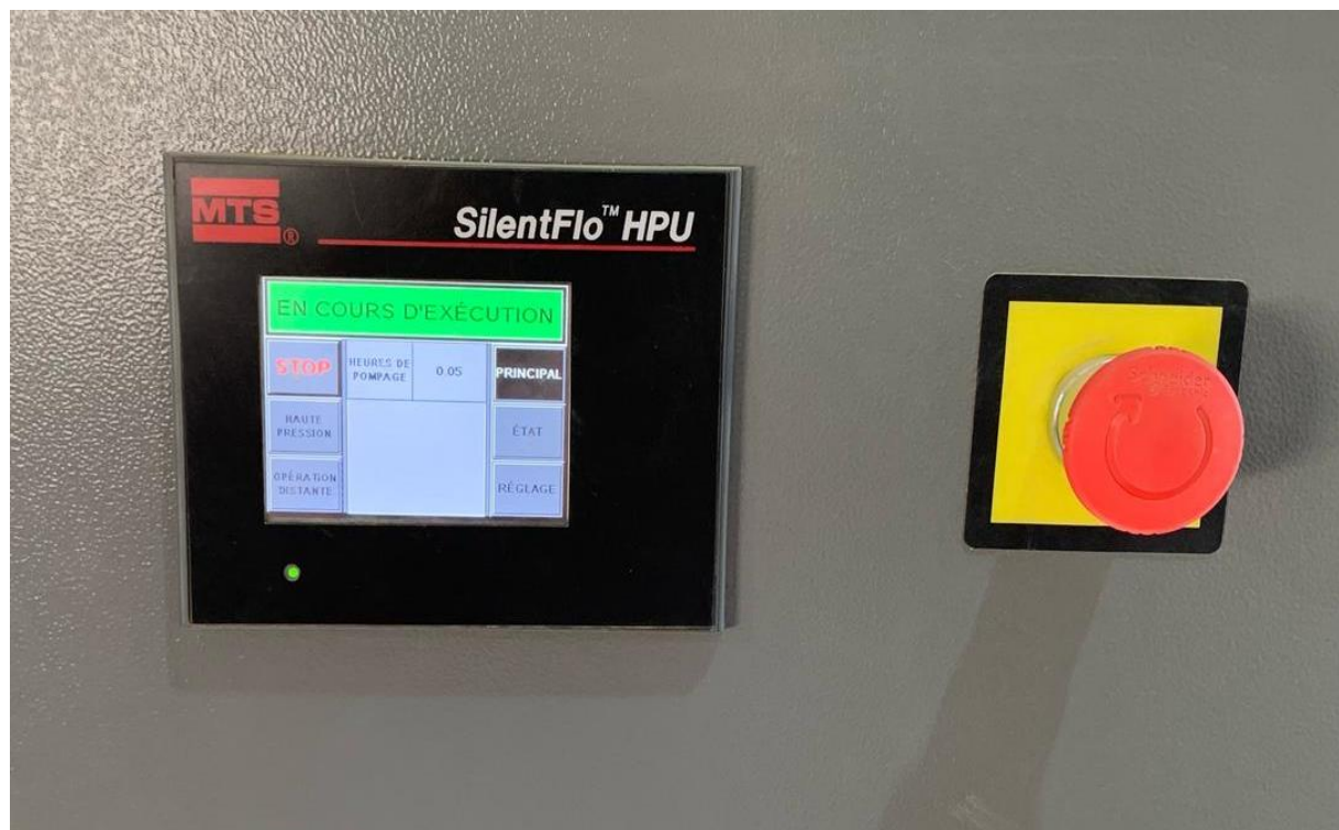
Figure 42 Fonctionnement de HPU manuellement ou à distance
