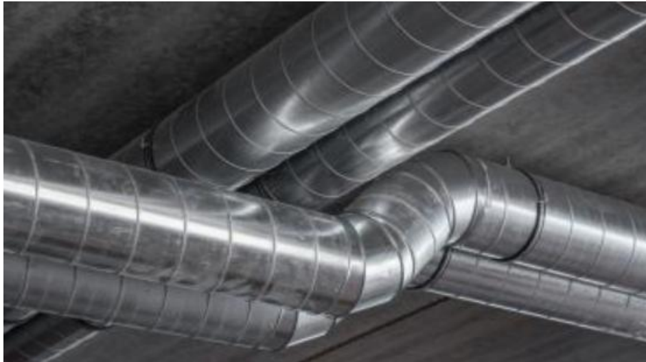
Figure 18 : Conduits de ventilation. [36]
