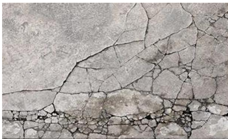
Figure 13: Exemple de fissuration due au retrait du béton
