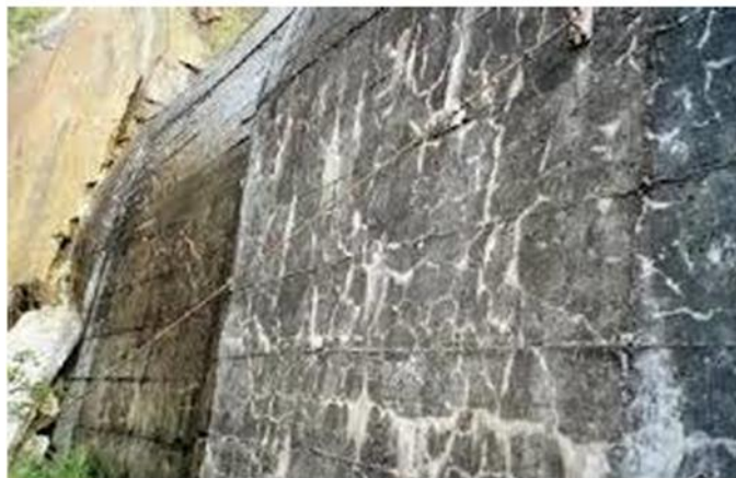
Figure 12: Béton dégradé par l'alcali-réaction
