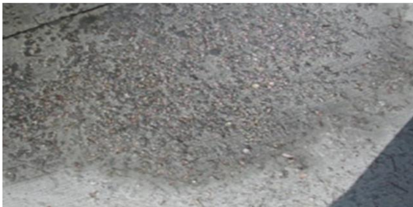
Figure 16: dégradation due aux sels de déverglaçage
