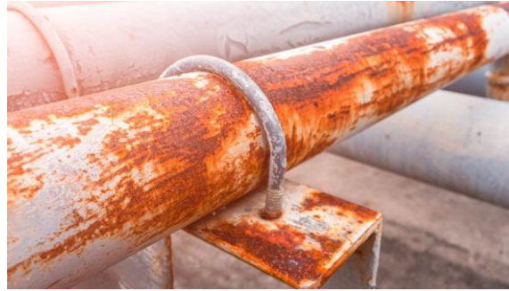
Figure I.1: Tuyaux métalliques corrodés (Dan Markham (Décembre 12, 2023))
