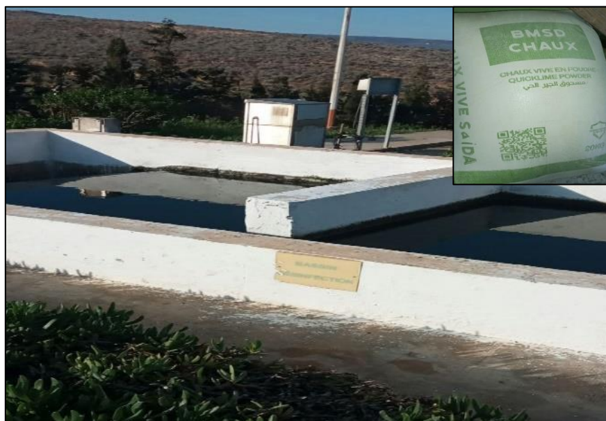
Figure II- 11 : Bassin désinfection par la chaux
