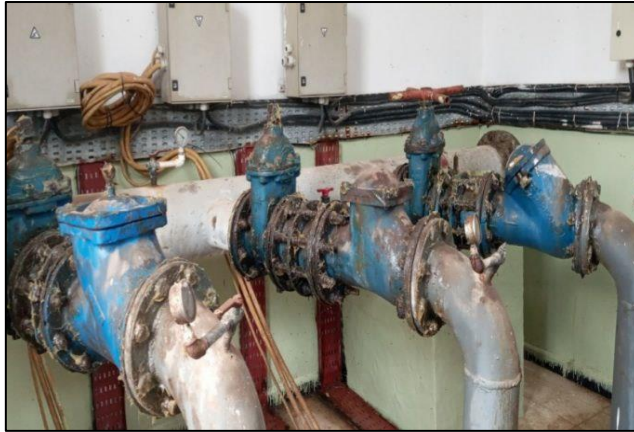
Figure II- 4 : la chambre des vannes
