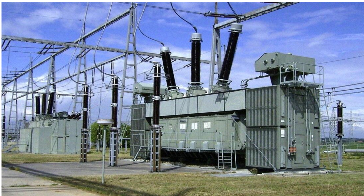
Figure I.1: Transformateur de puissance [2].
