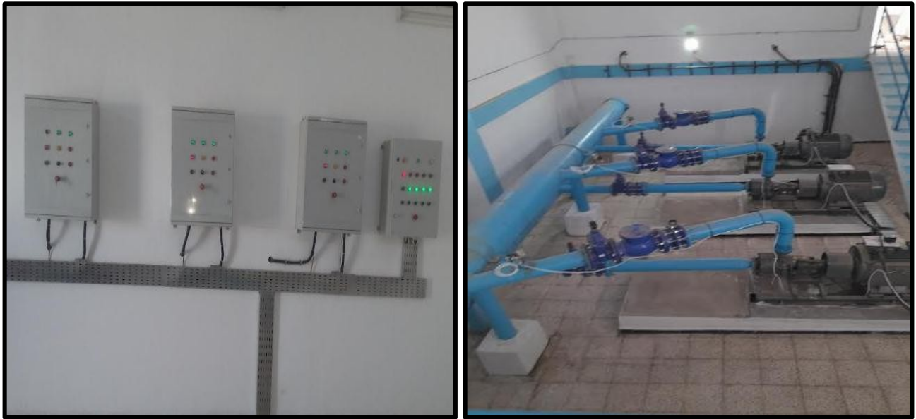
Figure IV-9 : Station de pompage de trois unités.
