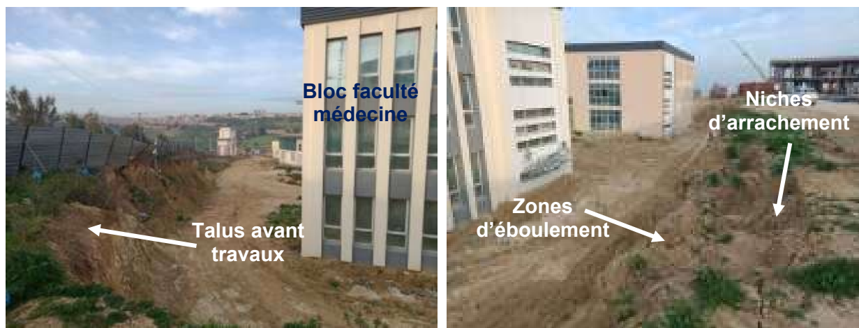
Figure 3.2 : Vue d'ensemble des talus avant la construction des murs de soutènement, mettant en évidence les dégradations de surface
