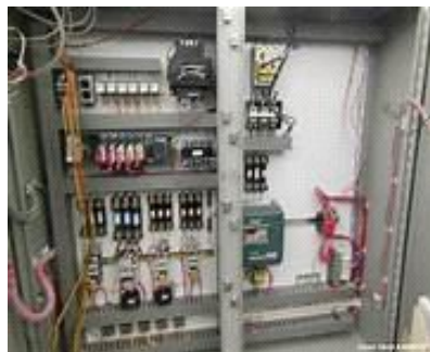
Figure 2.26 : l'armoire électrique d'une chambre froide [36]
