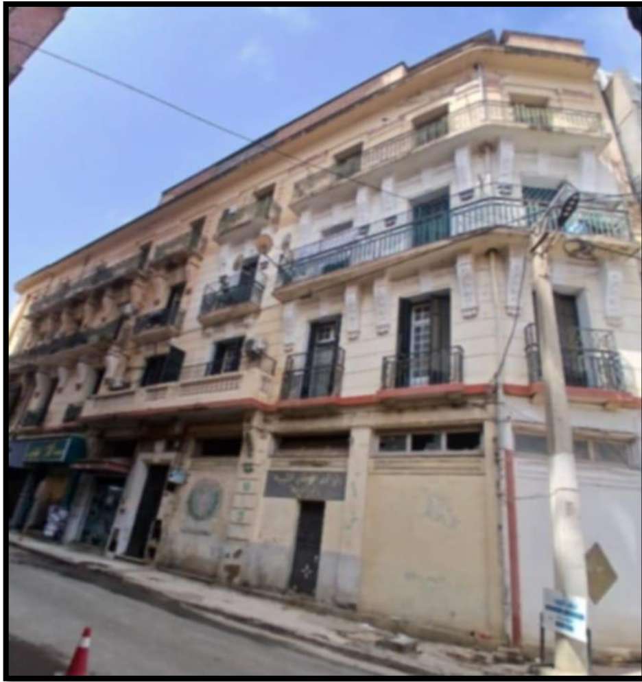
Figure 35 : Photographie de dégradation apparente du bâti colonial à Aïn Témouchent : altération des façades et signes de fragilité structurelle. (Source : Auteurs. Photographie prise le 12 mai 2026).
