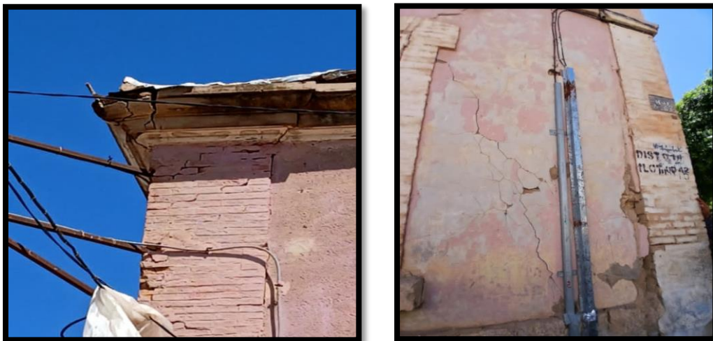
Figure 47 : Photographie de la mauvaise installation des câbles du réseau électrique.
