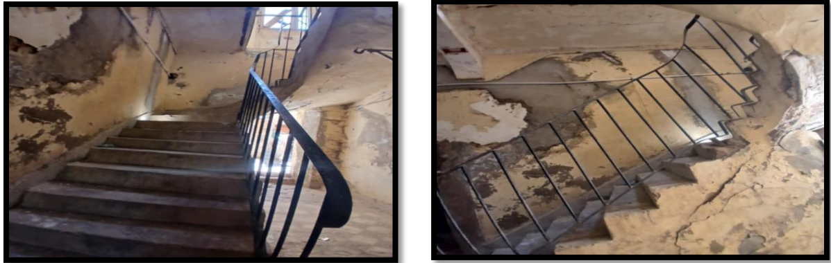
Figure 50 : Photographie de présence des fissures des marches et contre marches et manque (Source : Auteurs. Photographie prise le 1 mai 2026)
