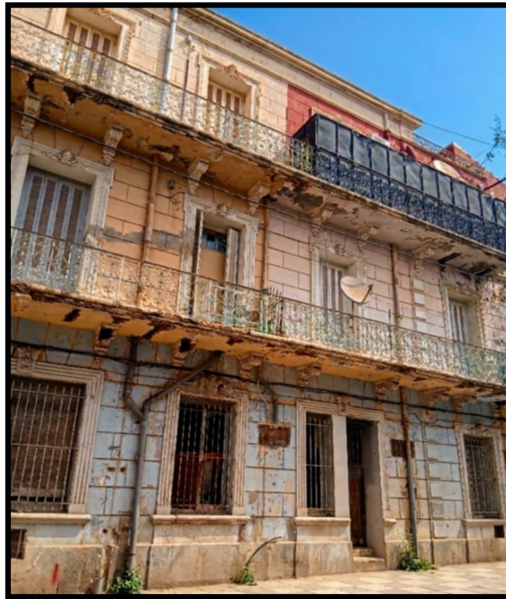
Figure 34 : Photographie de façade d'un immeuble résidentiel à l'abandon illustrant la dégradation physique et l'absence d'entretien.
