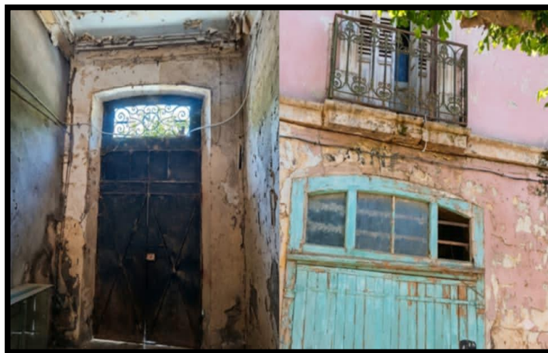
Figure 43 : Photographie de l'impact des ajouts anarchiques et de la corrosion métallique sur les entrées historiques.
