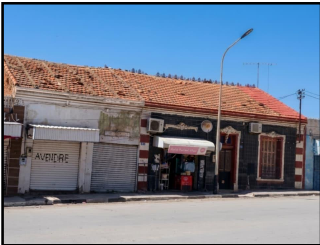
Figure 37 : Photographie de bâtiment colonial dégradé illustrant les difficultés économiques et techniques liées à la réhabilitation du patrimoine bâti à Aïn Témouchent.
