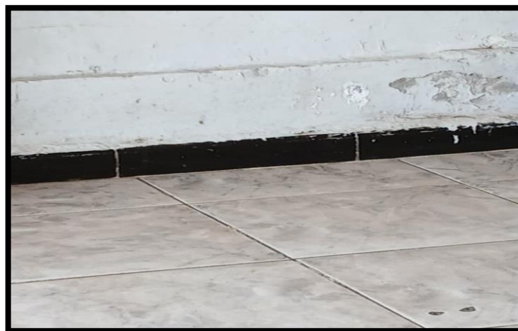
Figure 53 : Photographie de Manque des plinthes
