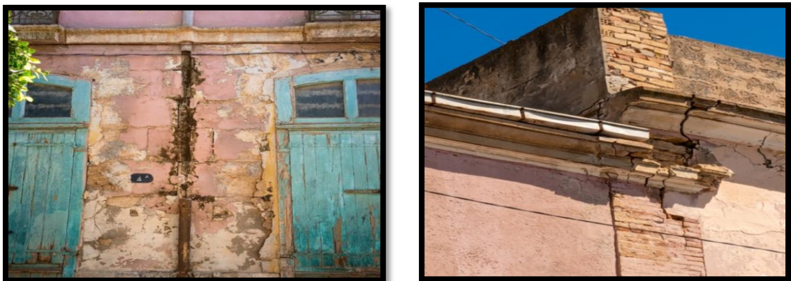
Figure 46 : Photographie de dégradation de la peinture extérieure d'un immeuble colonial.
