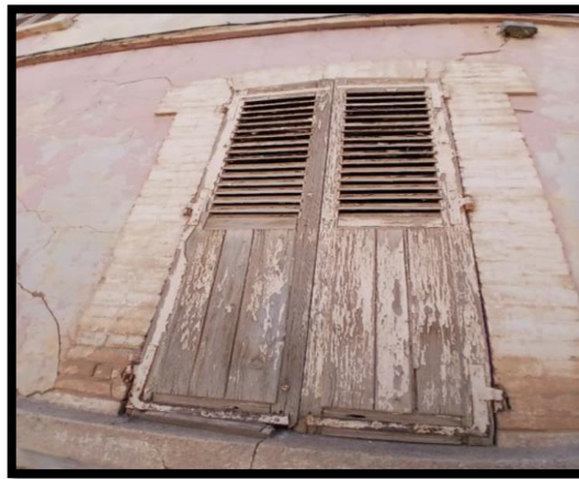
Figure 42 : Photographie d'Image d'une fenêtre d'un immeuble colonial en état de dégradation. (Source : Auteures. Photographie prise le 13 mai 2026).
