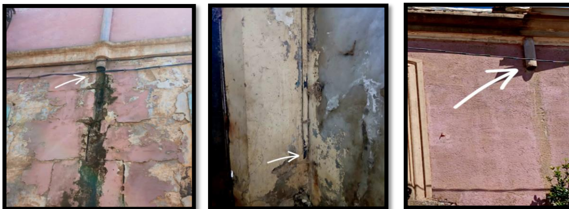
Figure 41 : Photographie de Dégradation Tuyau de descente d'eaux pluviales.
