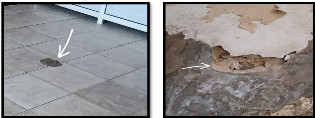
Figure 51 : Photographie de présence des fissures des marches et contre marches et manque. (Source : Auteurs. Photographie prise le 13 mai 2026)
