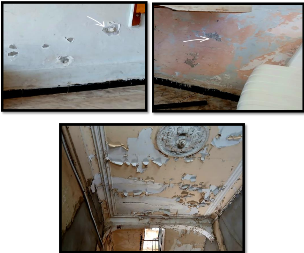
Figure 49 : Photographie de dégradation des surfaces et altération du revêtement (Source : Auteures. Photographie prise le 1 mai 2026)
