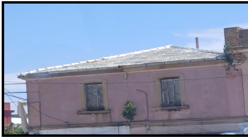
Figure 54 : Photographie de dégradation de la toiture en tuiles.
