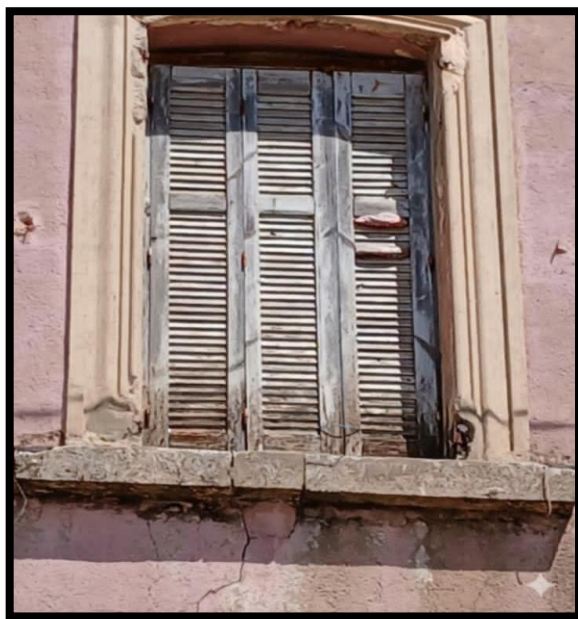
Figure 44 : Photographie d'Image d'une fenêtre d'un immeuble colonial en état de dégradation.
