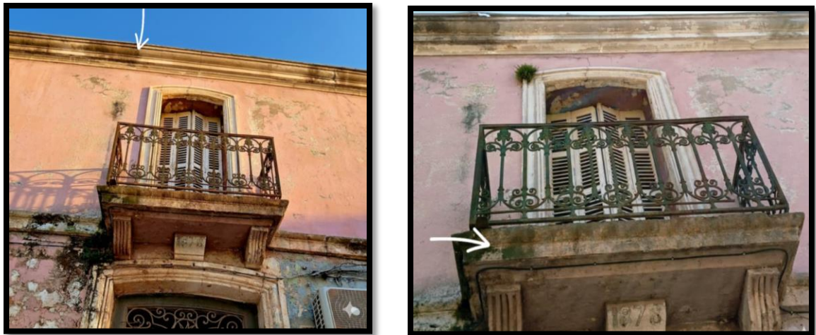
Figure 45 : Photographie de dégradation des éléments de menuiserie.
