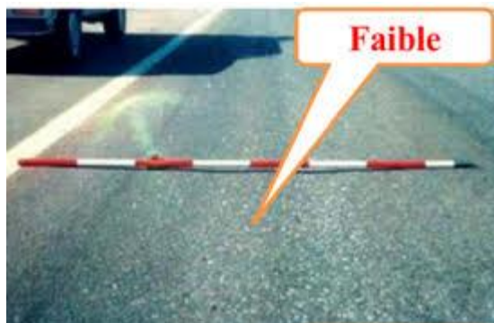
Figure 31: Ornières à petit rayon [5].
