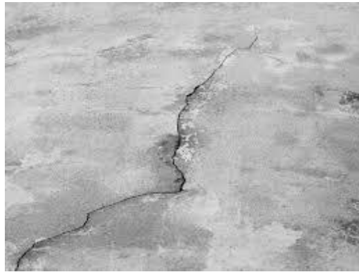
Figure 27: Fissures en dalle [5].
