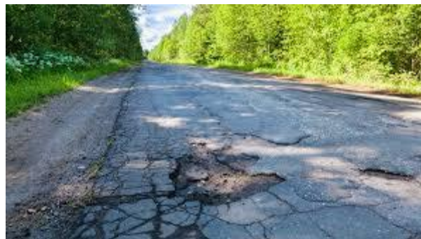
Figure 33: Affaissement de rive [5].
