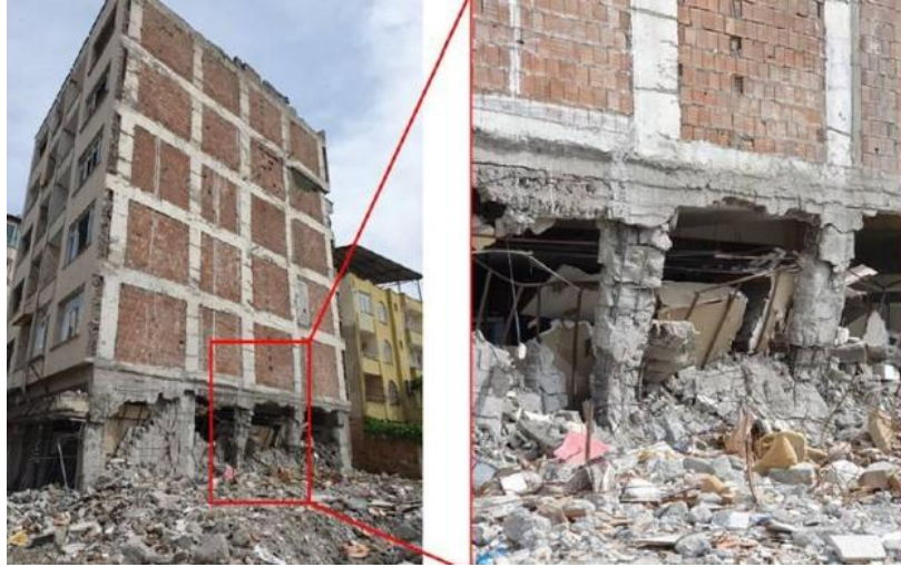
Figure 1.7. Effondrement par mécanisme d'étage souple (Paulay & Priestley, 1992)
