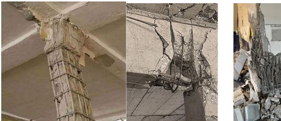
Figure 1.6. Flambement des poteaux sous charges sismiques (Kramer, 1996)
