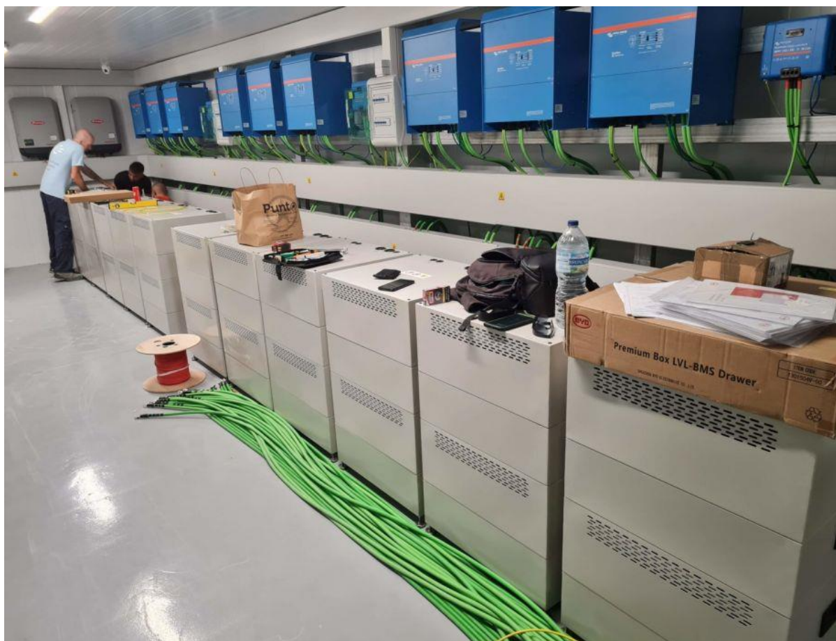
1. Figure III 9 installations l'énergie solaire
