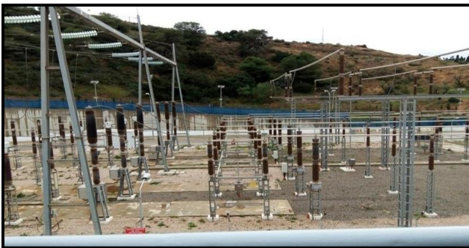
Figure 31 : le réseau électrique de la SDEM de Béni Saf (BWC)
