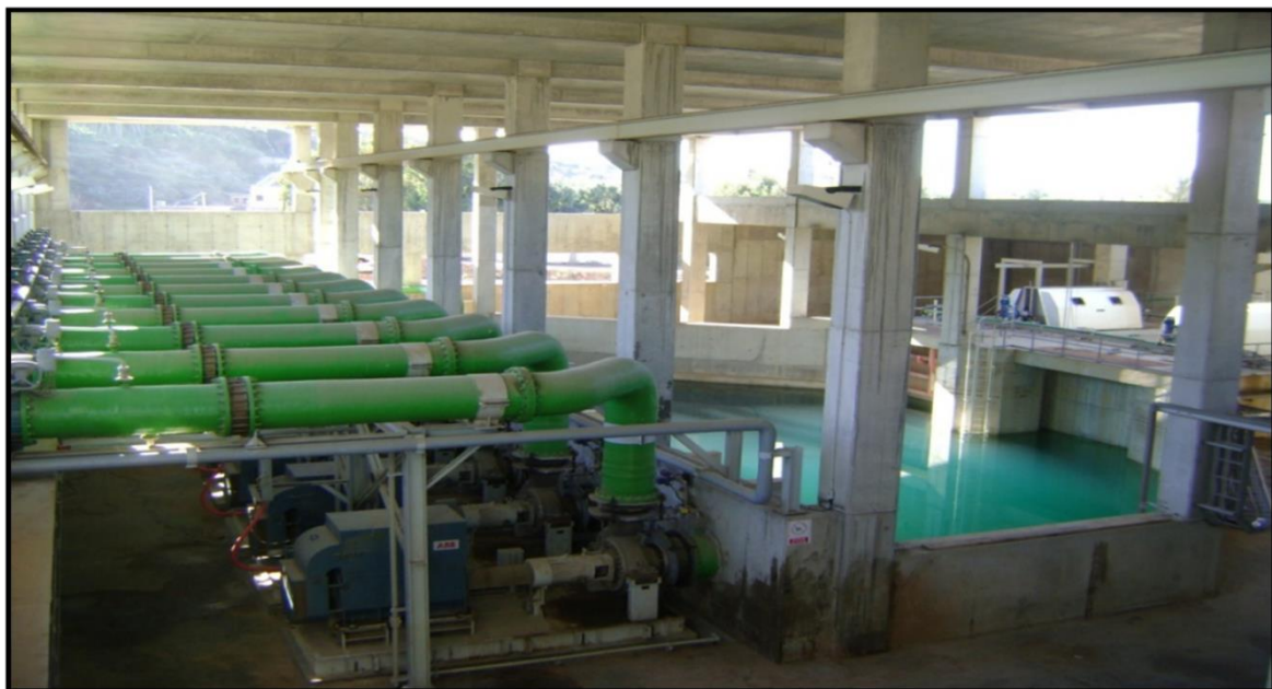
Figure 19 : Zone de captage (BWC)
