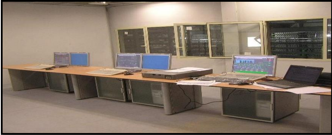
Figure 30 : Salle de contrôle (BWC)
