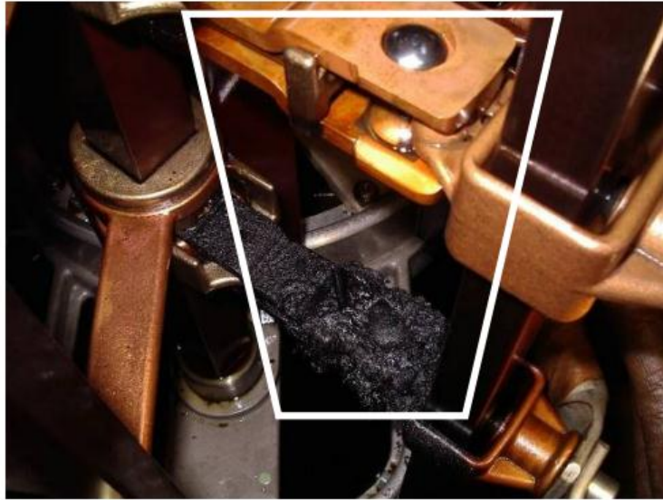
Figure 2.3: Point chaud sur le sélecteur d'un régleur en charge [37]
