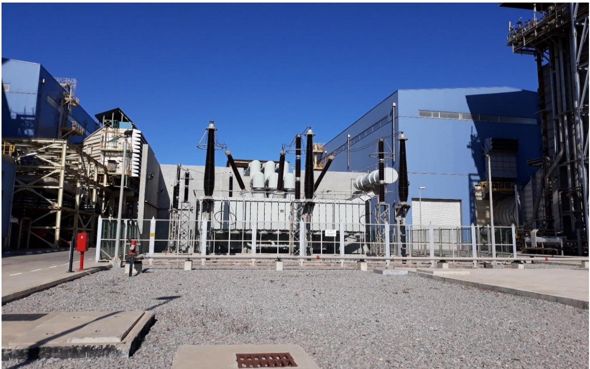
Figure 1.1: Transformateur principal d'évacuation vers le réseau HT – Centrale électrique de TERGA
