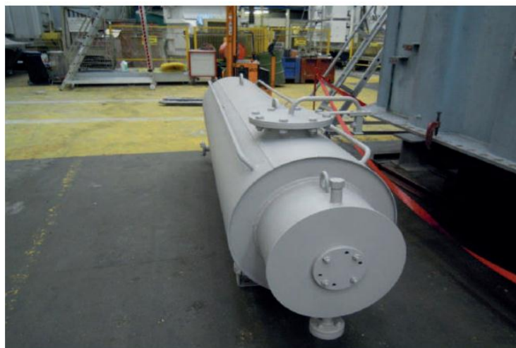
Figure 1.15 : Conservateur d'huile de transformateur
