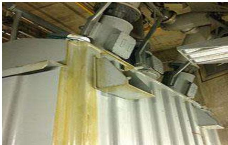
Figure 2.4: Fuite d'huile de transformateur [8]
