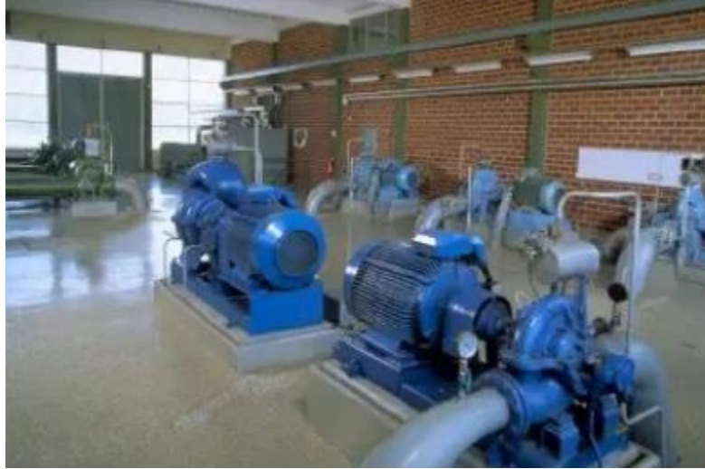
Figure II.34: fonctionnement des pompes.
