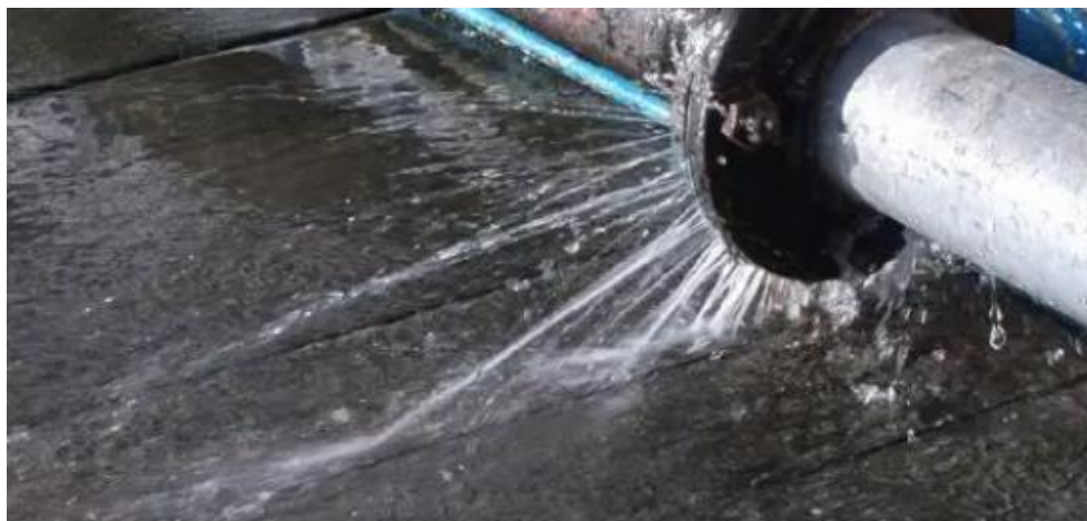
Figure II.36: pertes d'eau dans les réseaux de distribution.
