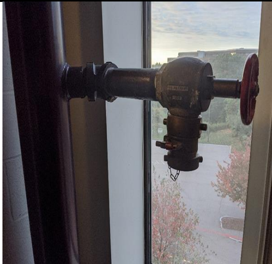
Figure 17 Colonne montante Classe I[15]
