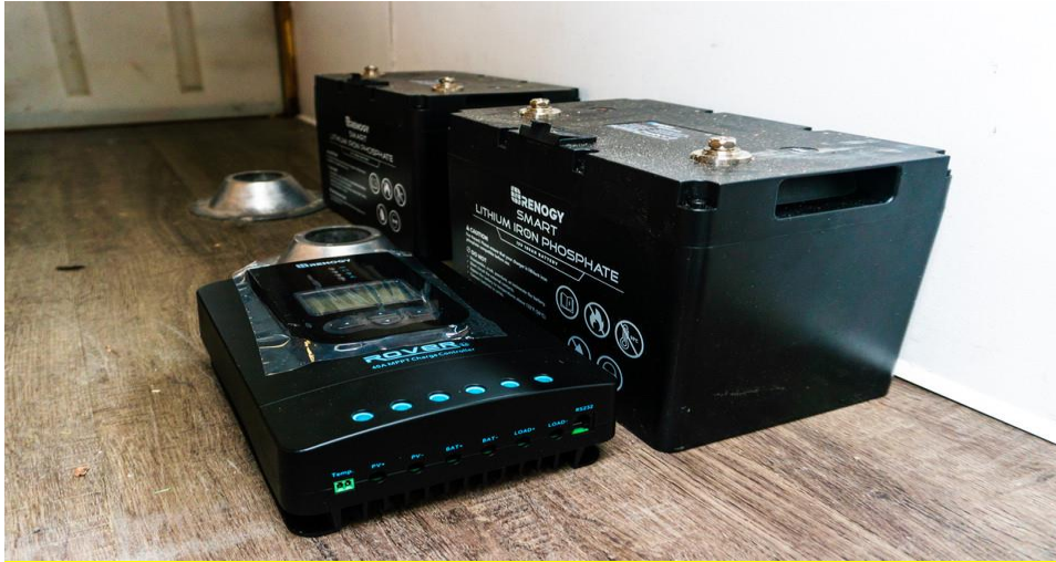
Figure (II.7) : Les batteries
