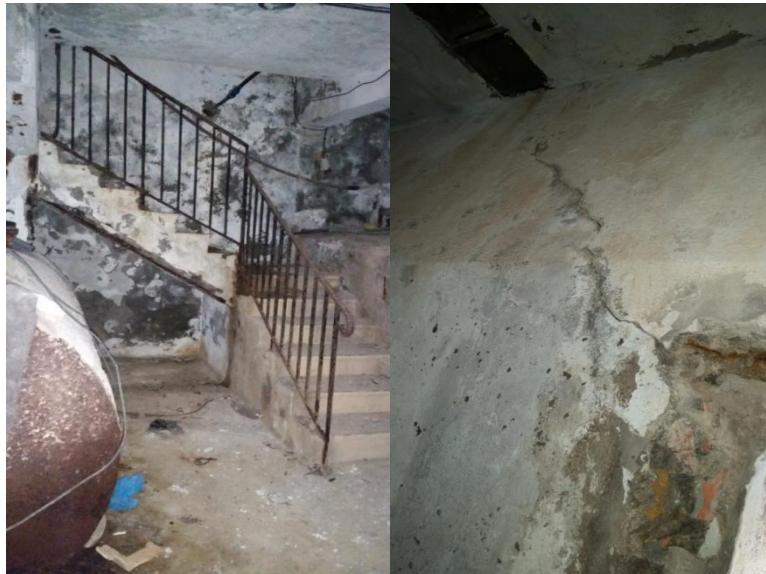
Figure 5-15 : Les escaliers et Fissuration de mur.
