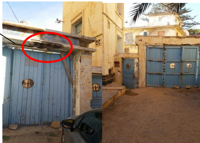
Figure 5-10 : Photo a gauche la porte a l'extérieur et la photo à droite la porte a l'intérieur
