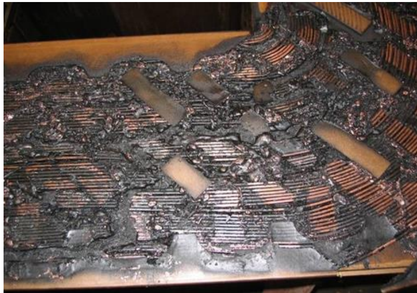
Figure 2.7: Court-circuit entre spires
