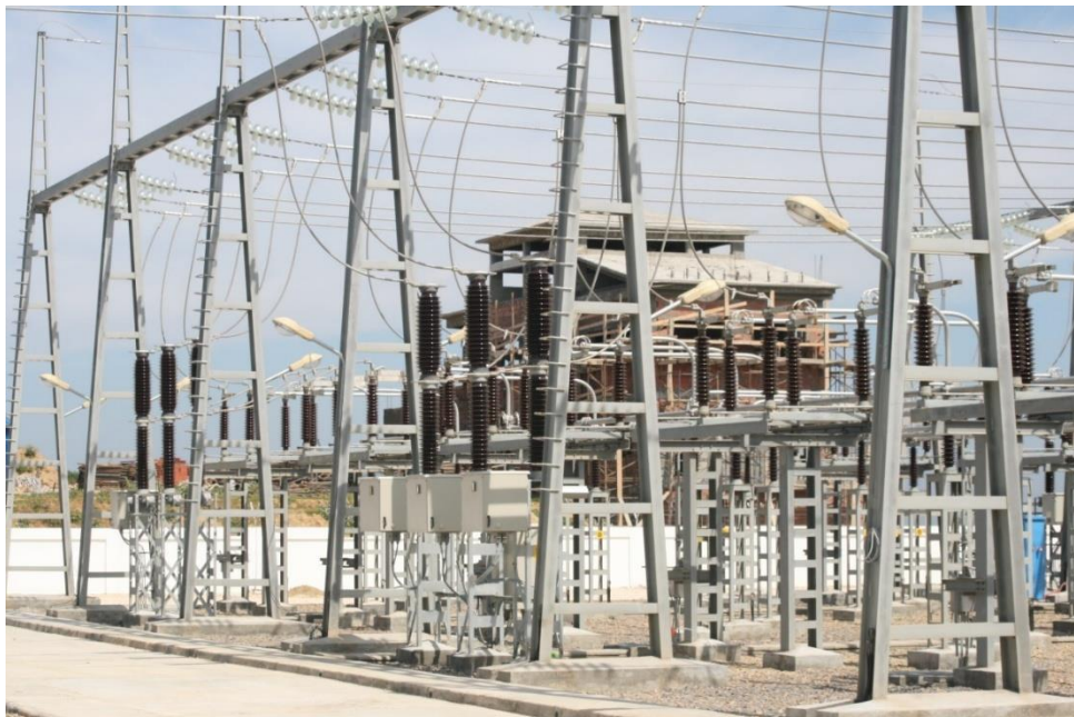
Figure 1.18 : un transformateur de grande puissance dans un poste électrique extérieur
