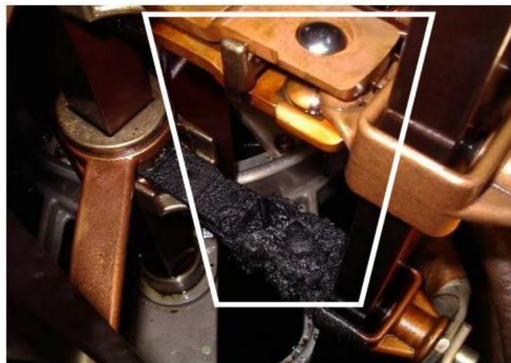
Figure 2.6 : Point chaud sur le sélecteur d'un régleur en charge
