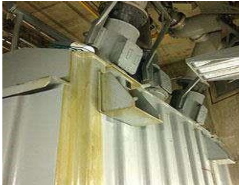
Figure 2.8: Fuite d'huile de transformateur
