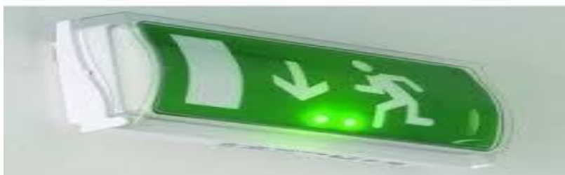
Figure II-3 Eclairage de sécurité
