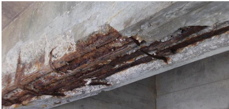
Figure II-20 Exemple de corrosion [56]
