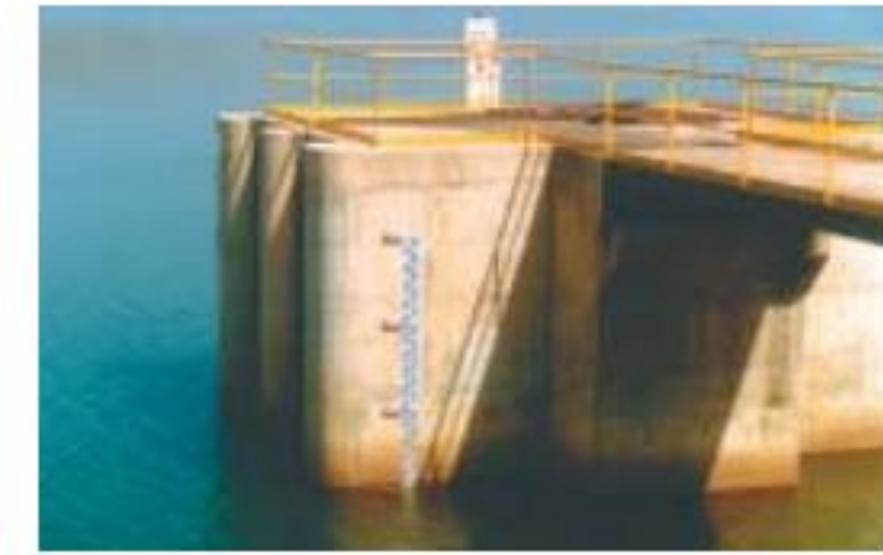
Figure 31 : Echelle limnimétrie installée sur une tour de prise. [25]
