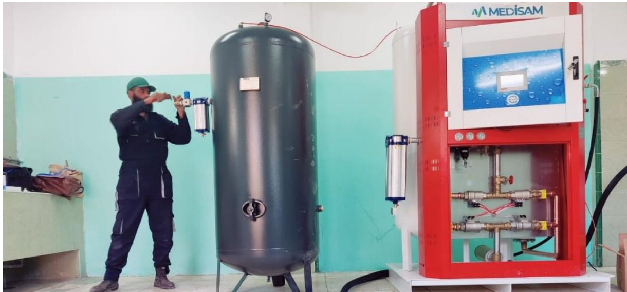
Figure III.2 : Centrale de distribution de l'oxygène à l'hôpital de Saida
