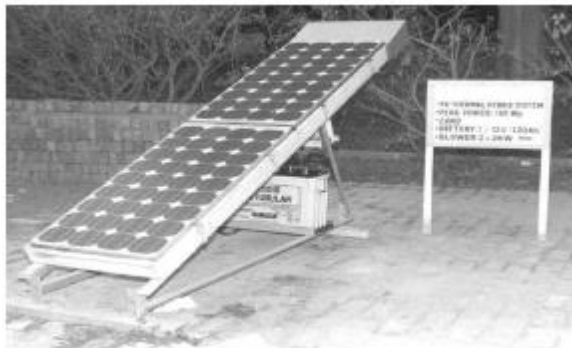
FIGURE 36 : BANC D'ESSAI DU CAPTEUR SOLAIRE PV-T HYBRIDE A AIR [83]
