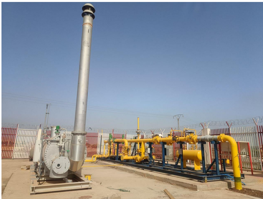
Figure I.1. Poste détente gaz sidi ben aada 10.000 m 3 /h
