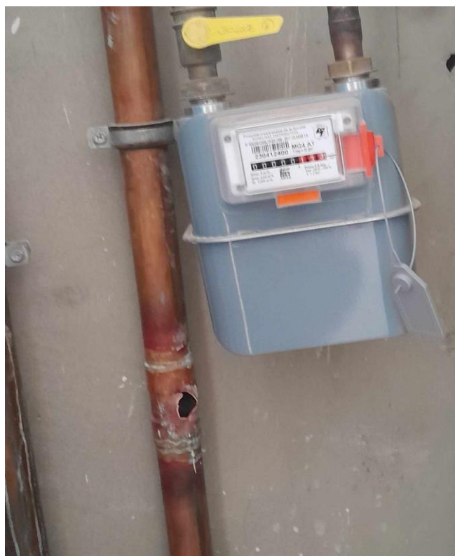
Figure I.2 Une colonne montante se détériore suite à un vol.
