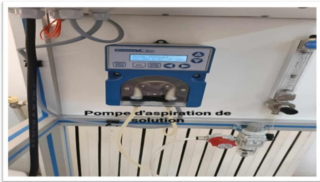
Figure.V.3: Pompe d'aspiration de solution MDEA.
