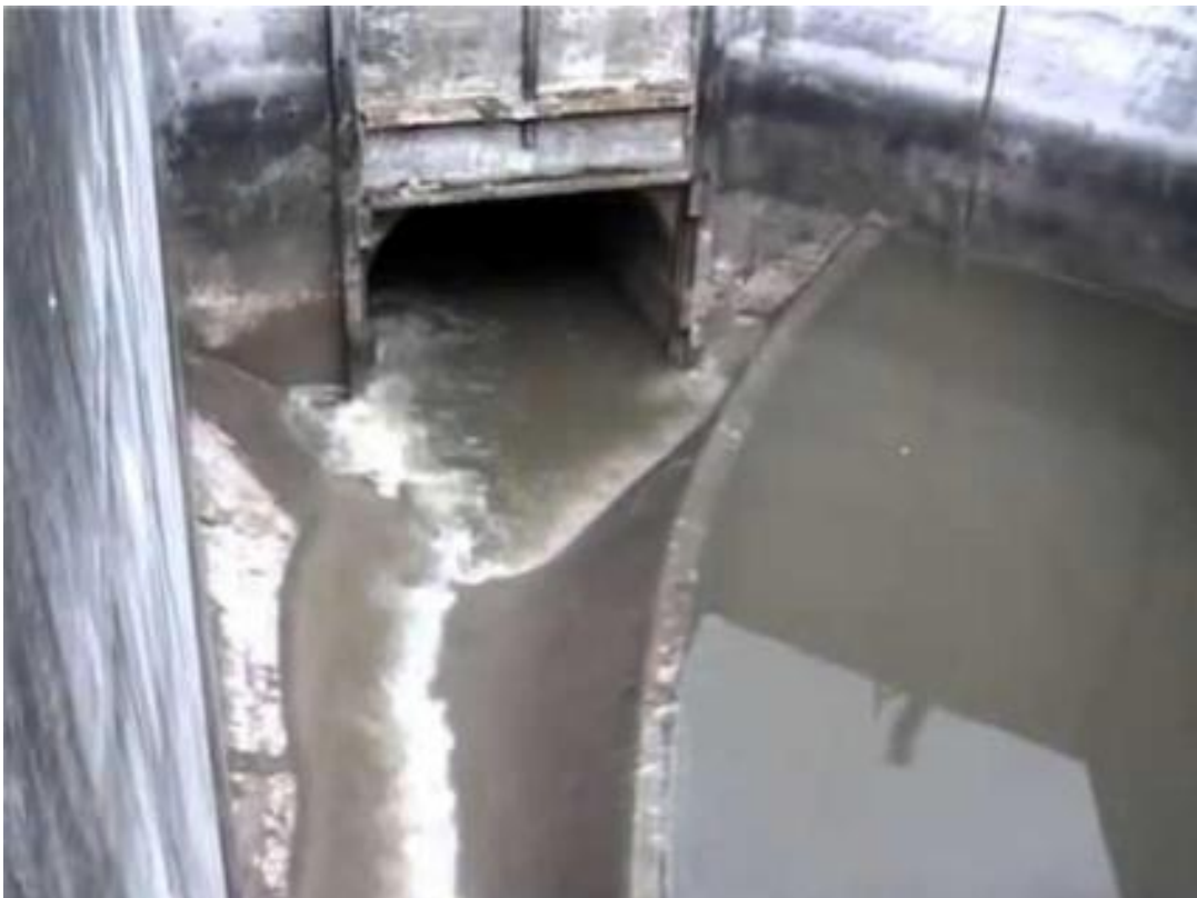
Figure 15 : Un déversoir d'orage
