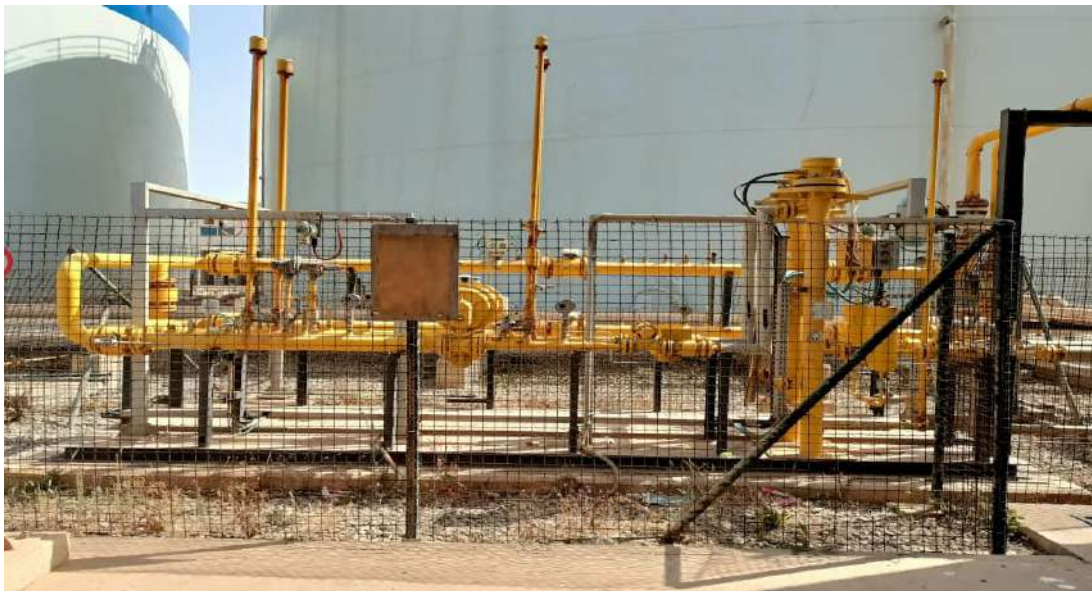
Figure (III.17) : Poste de gaz de dessalement.
