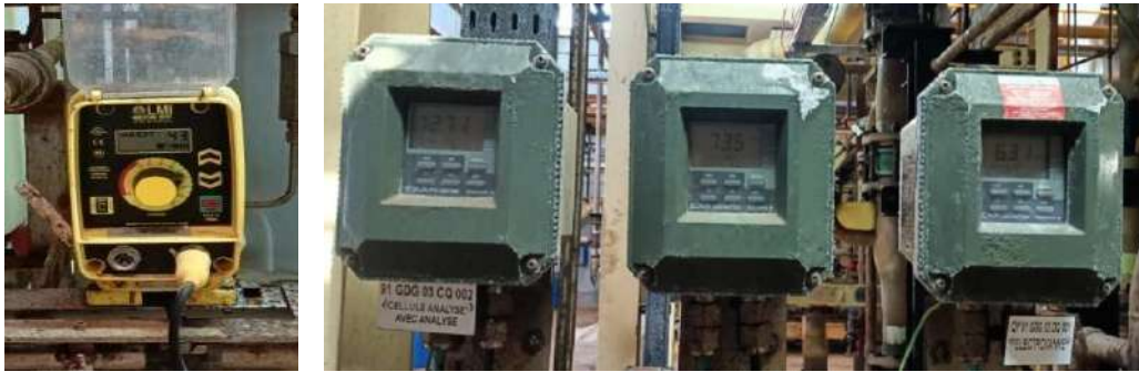
Figure (III.19) : Les instruments de mesure installés.
