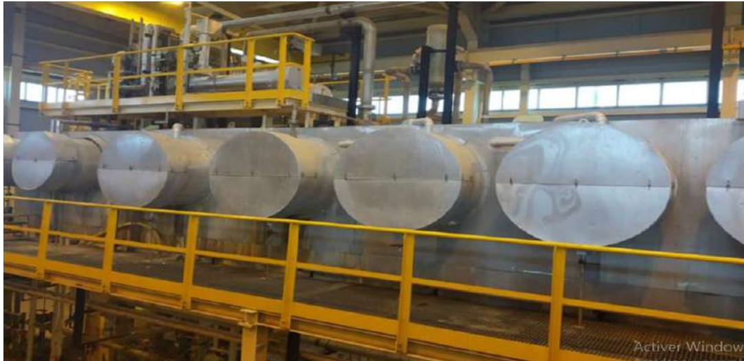
Figure (II.15) : Unité de Production d'eau dessalée MSF.
