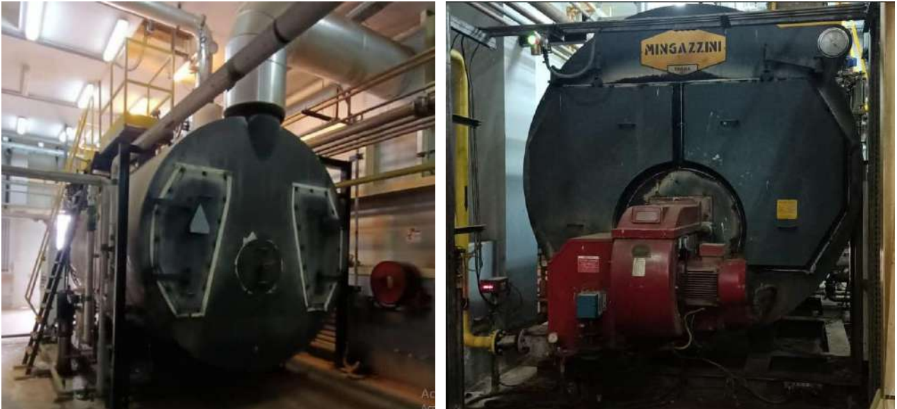
Figure (III.9) : La chaudière à vapeur.
