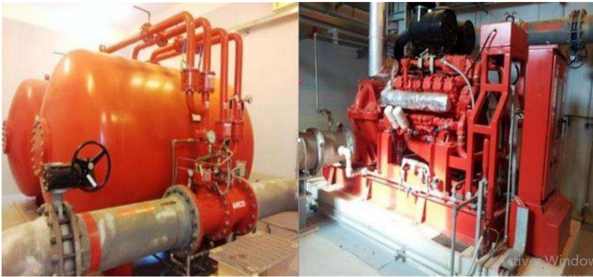
Figure (II.19) : Equipements de protection contre les incendies.
