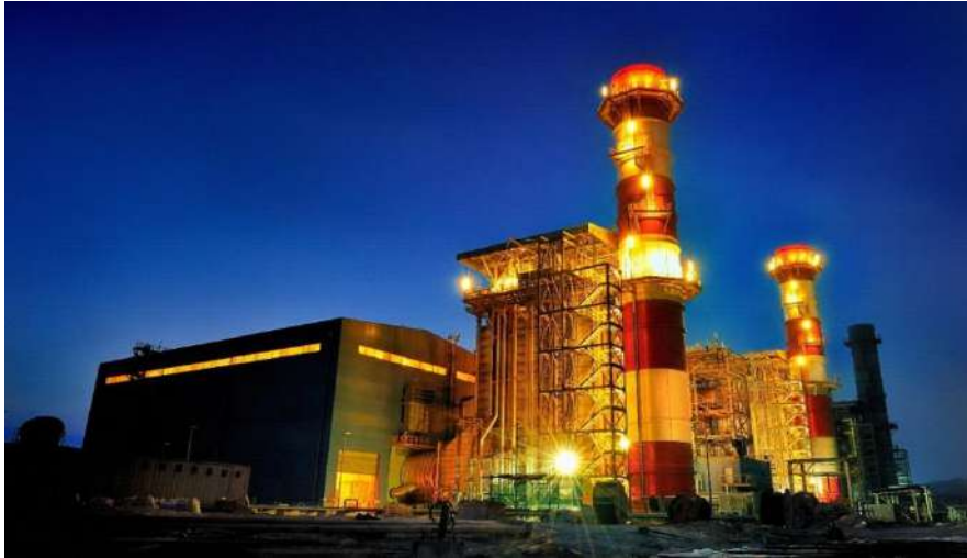
Figure (II.6) : L'unité de production d'énergie électrique.
