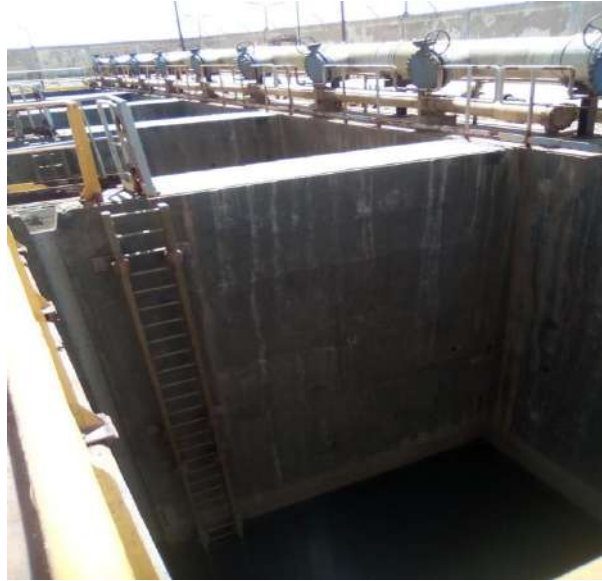
Figure (III.1) : Station d'entrée d'eau de mer.
