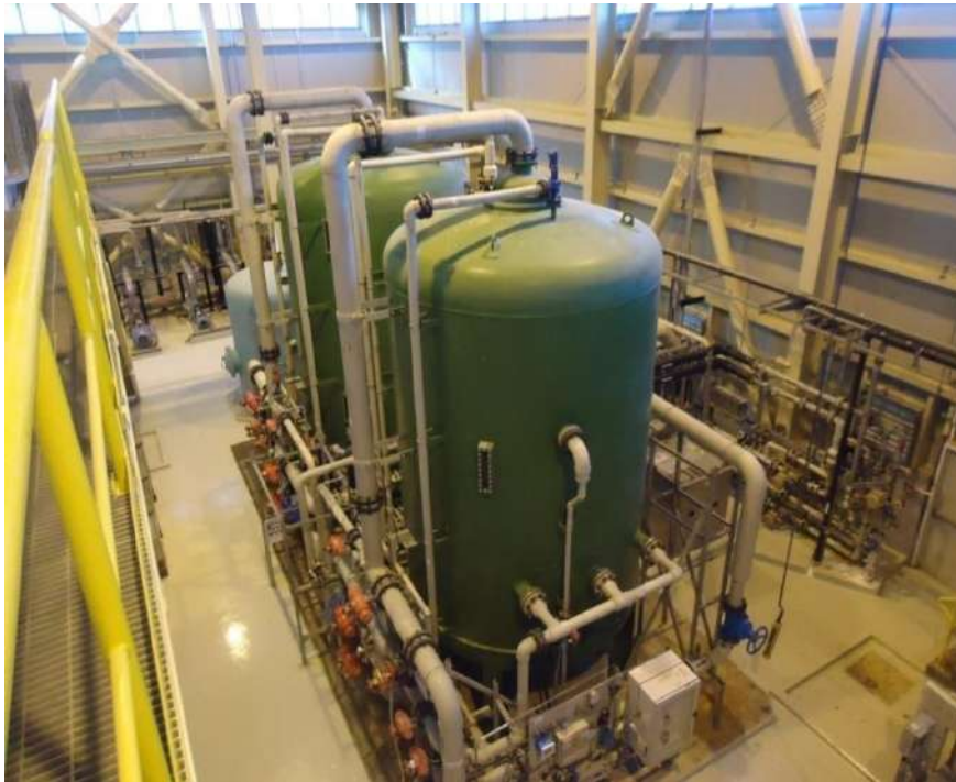
Figure (II.17) : L'Unité de déminéralisation
