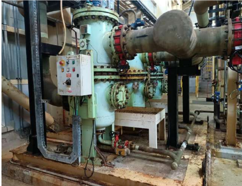
Figure (III.7) : Les filtres d'eau de mer entrée dans l'unité de production d'eau dessalée.
