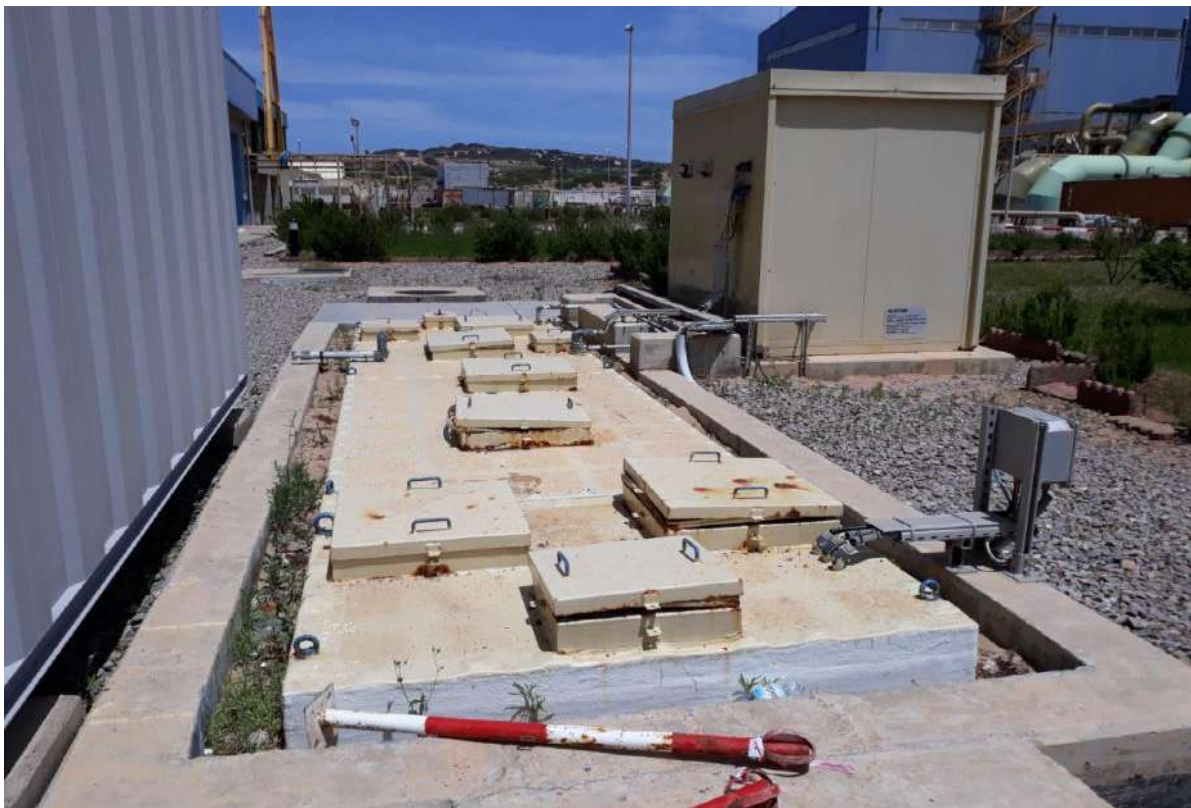
Figure (II.23) : Station de traitement des eaux usées.
