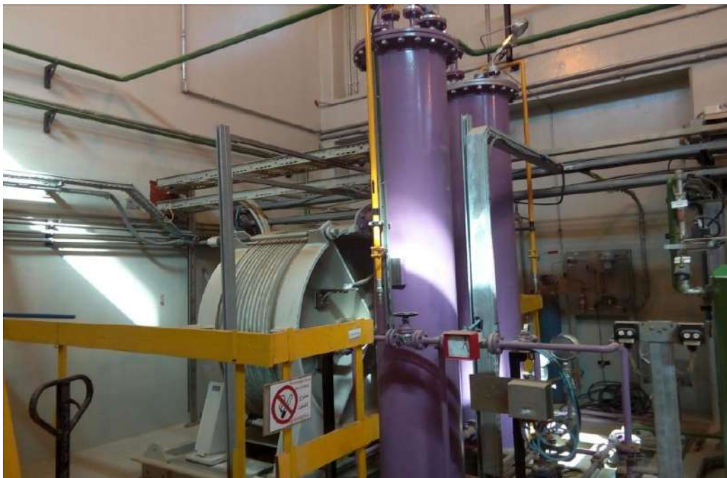
Figure (II.18) : La station de production d'hydrogène
