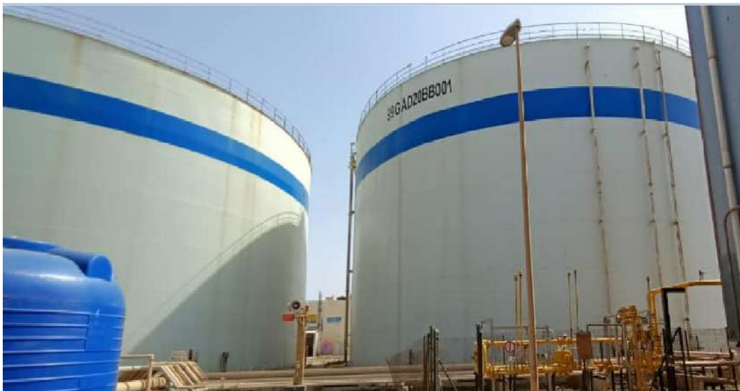
Figure (III.18) : Les réservoirs de stockage pour les deux unités de dessalement.
