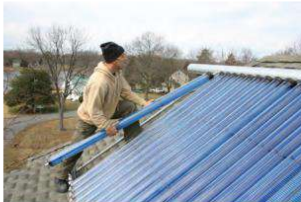
Figure (III, 5) : tubes sous vide installée dans une toiture [22].
