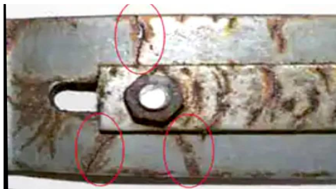
Figure I.14. Fissuration par corrosion sous contrainte d'un assemblage après 4 ans dans une piscine intérieure [20]
