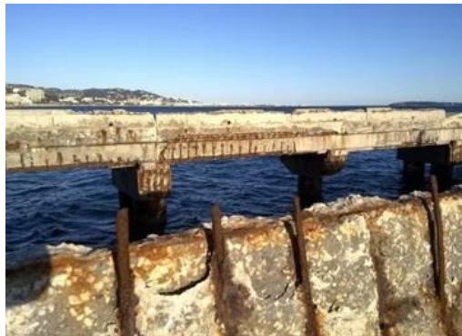
Figure I.3. Dégradation du béton armé [4]
