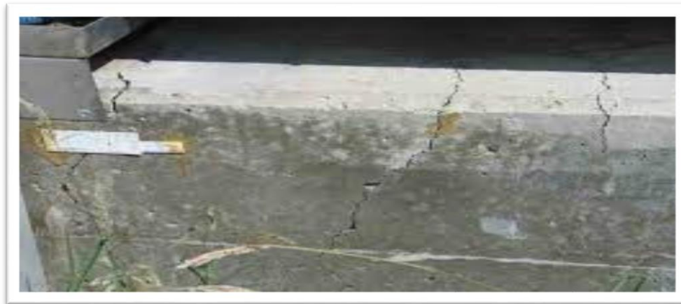
Figure 1. 7 La réaction sulfatique interne dans les bétons [15]
