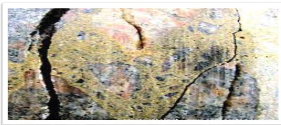
Figure 1. 6 L'alcali réaction sur un béton [8]
