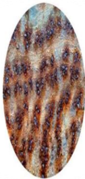
Corrosion par piqûres
