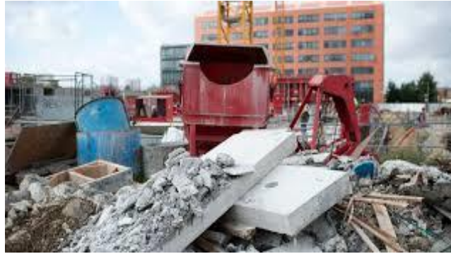
Figure I.10. Déchet de BTP
