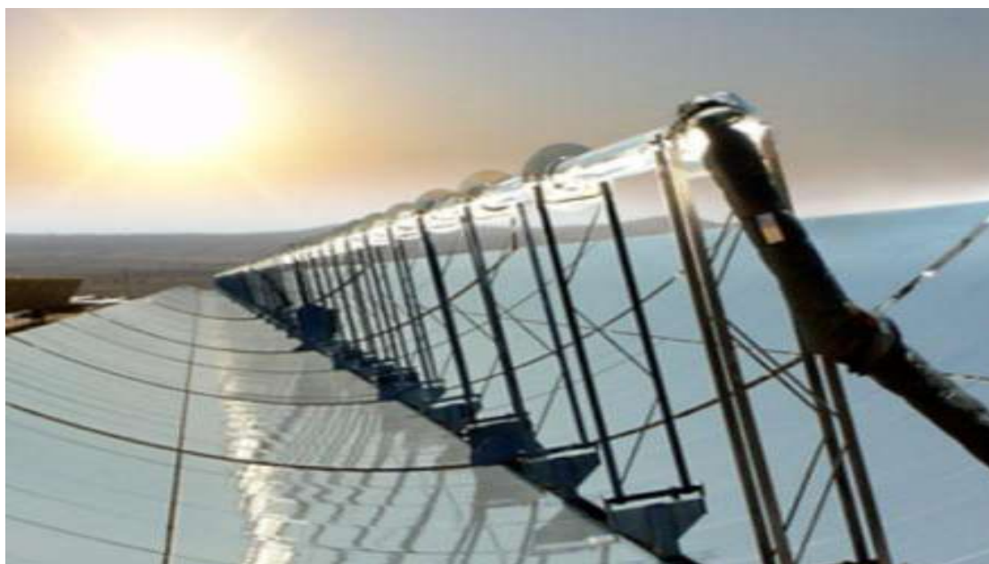
Figure I-10 : capteurs cylindro-paraboliques de la centrale Nevada solar one
