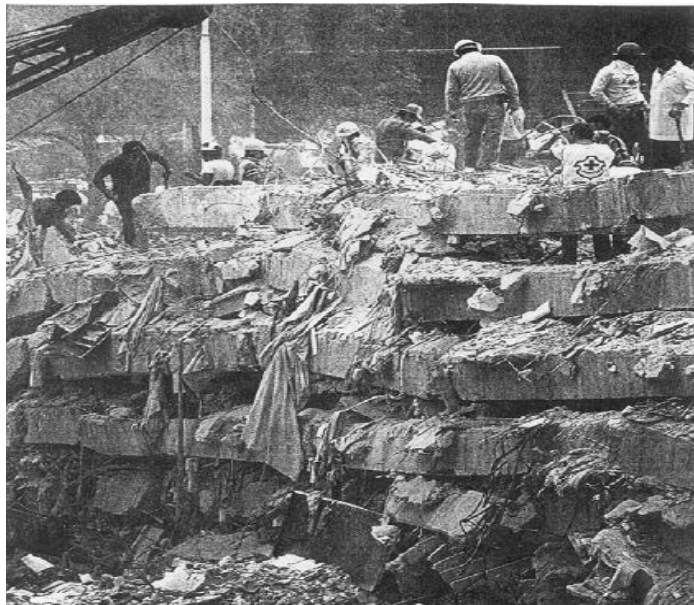
Figure 15.2 Effet de la ruine de poteaux faibles : l'empilement des planchers après séisme [2]
