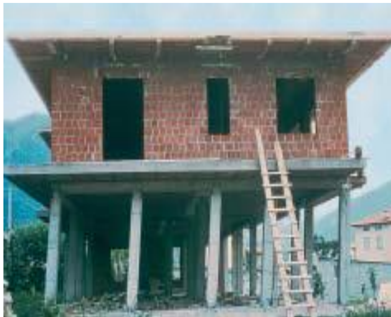
Figure 8.2 Le mécanisme de colonnes ayant affecté le rez-de-chaussée de ce bâtiment en construction a failli provoquer son effondrement (Frioul, Italie, 1976) [5]
