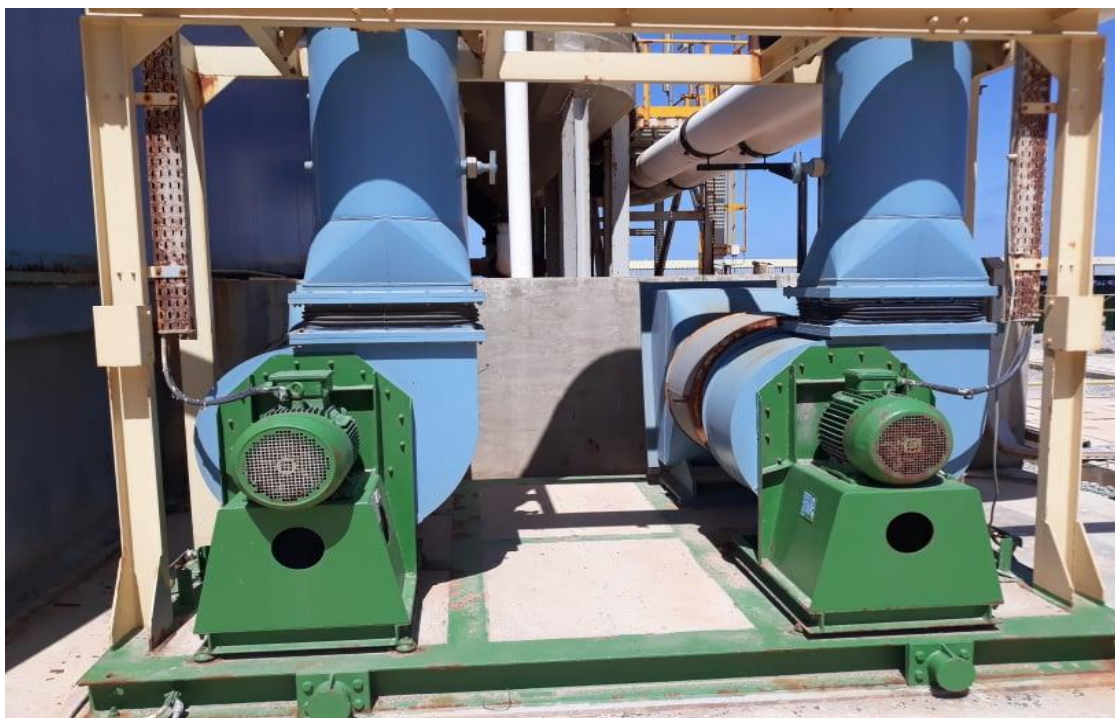
Figure 23 Ventilateurs de circulation d'air
