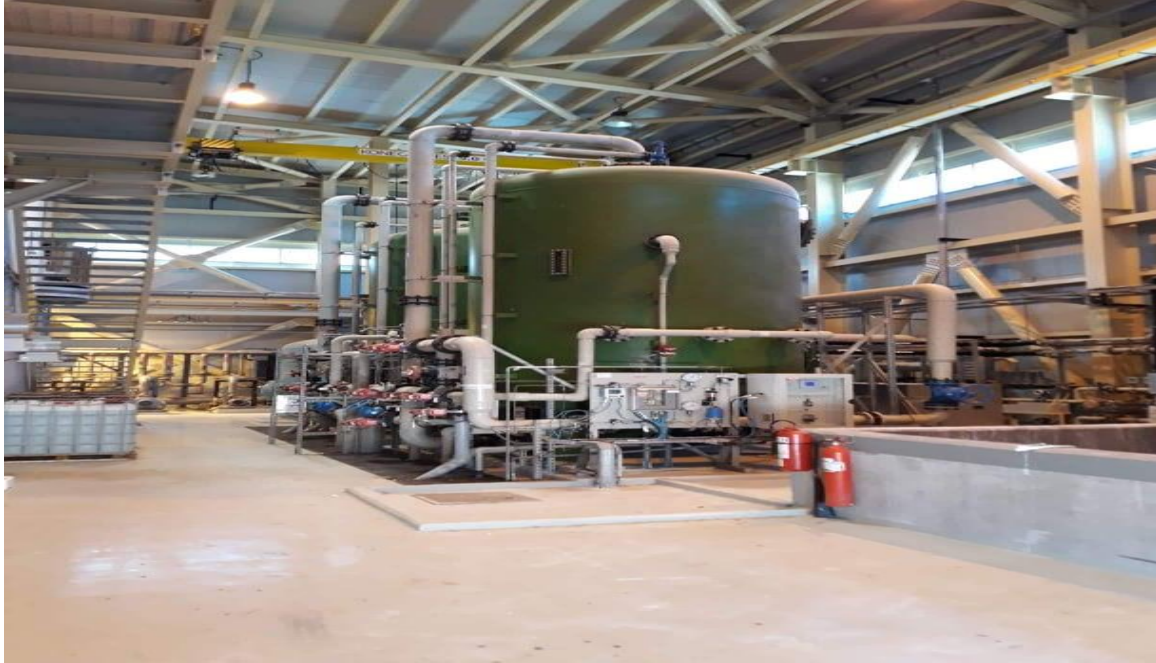
Figure 13 unités de déminéralisation
