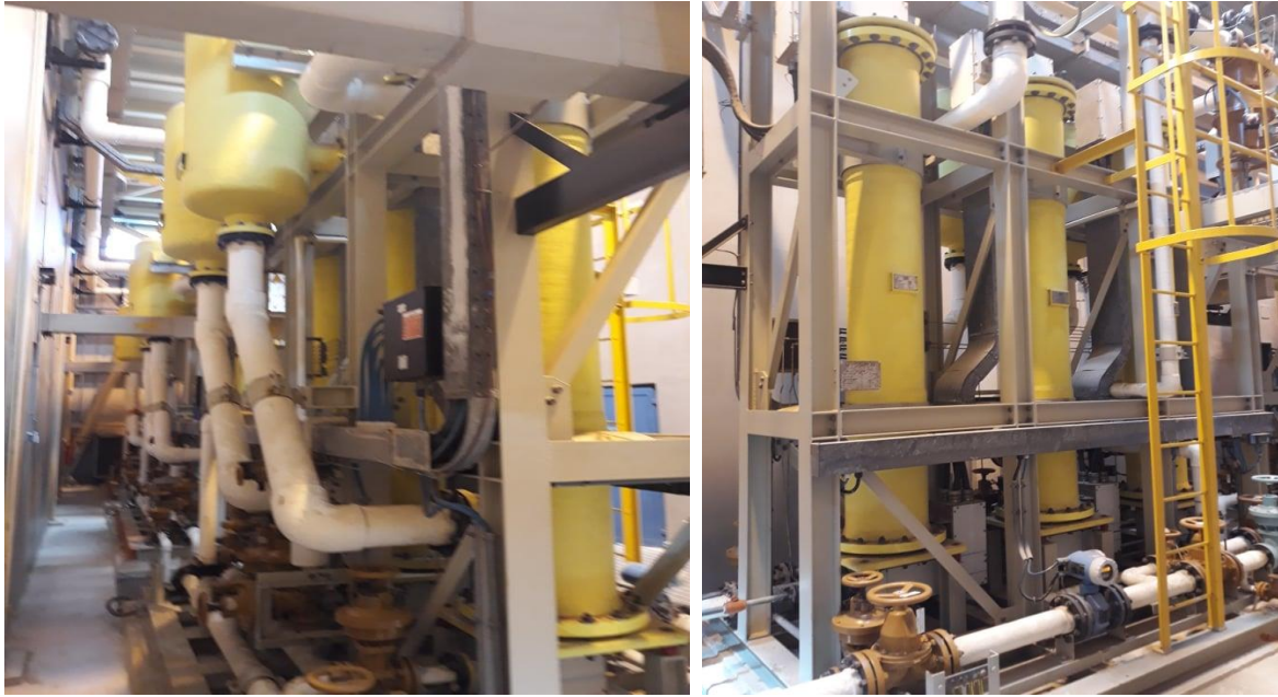
Figure 32 Vue réelle des électrolyseurs
