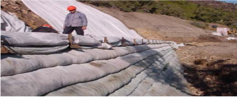
Figure 3.11 : parement préfabriqué devant le massif en géotextile (service d'étude technique des routes et autoroutes(SETRA). [25]
