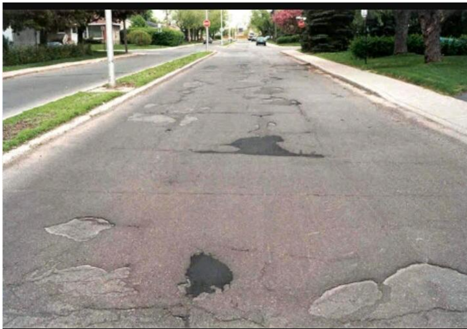
Figure 41:Photo de la dégradation type pelade
