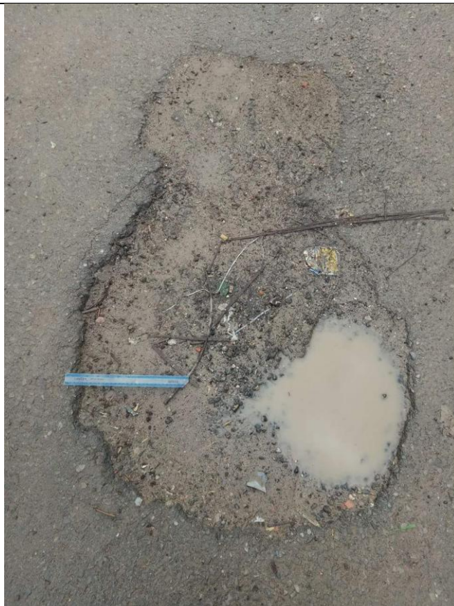
Figure 42:Photo de la dégradation type nid poule
