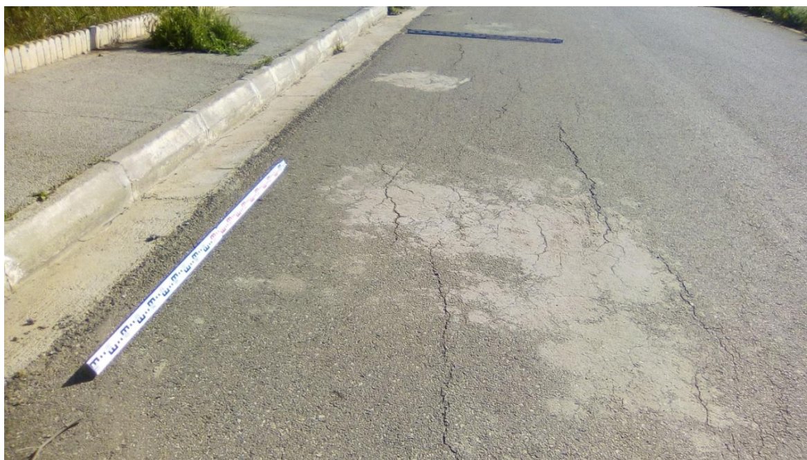
Figure 39:Photo montre les fissures longitudinale
