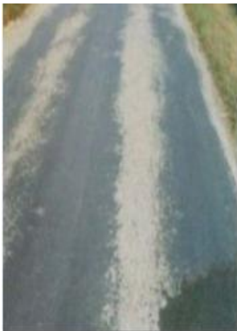
Figure 45: Photo prise de dégradation du type ressuage
