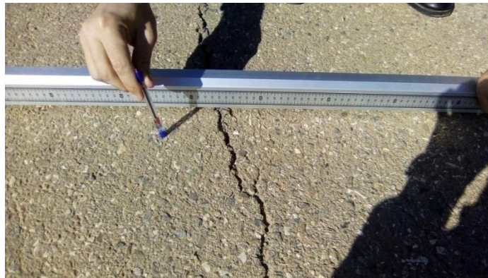
Figure 32: Photo de dégradation due à la fatigue de la chaussée
