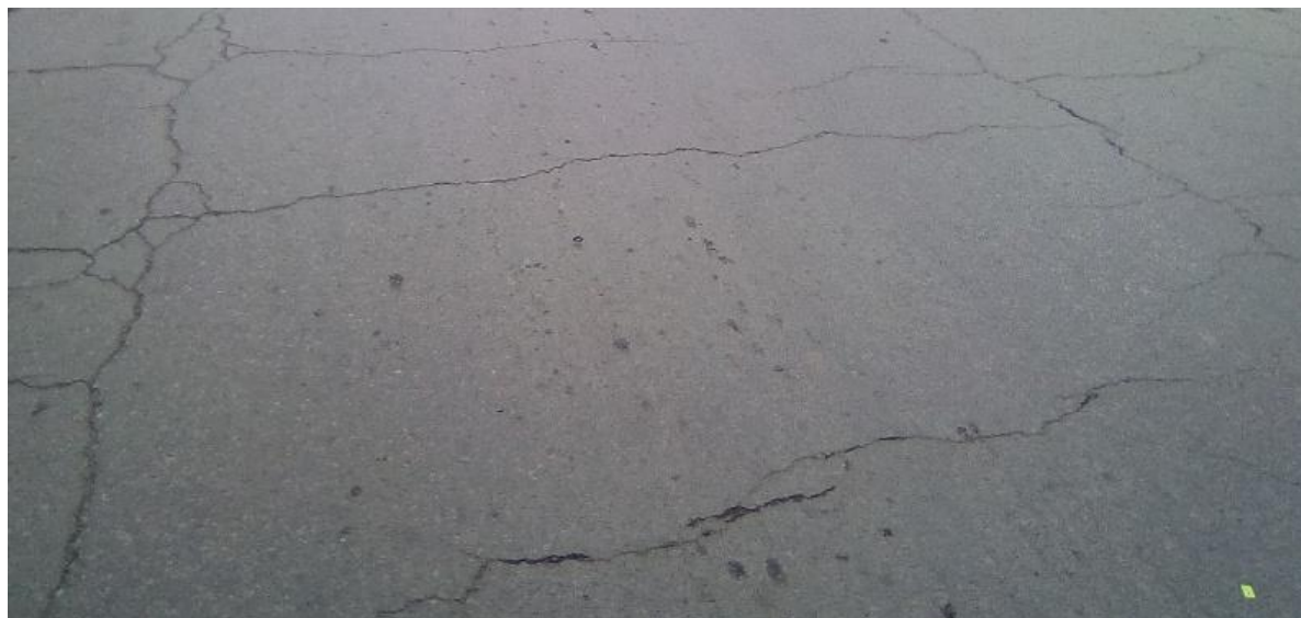
Figure 38:Photo du dégradation type fissure transversal
