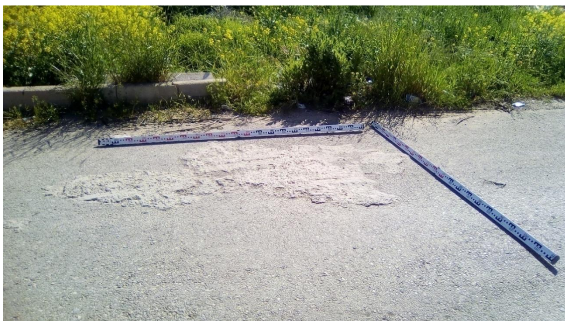
Figure 34: Dégradation due à la non-conformité des travaux
