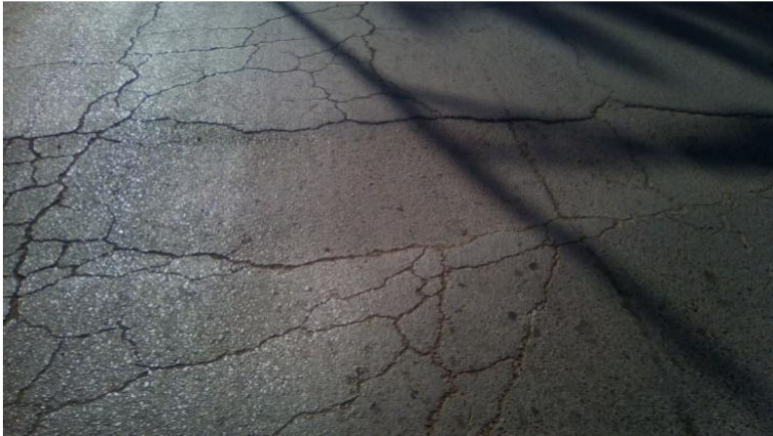
Figure 36: Photo prise sur dégradation de type flache.
