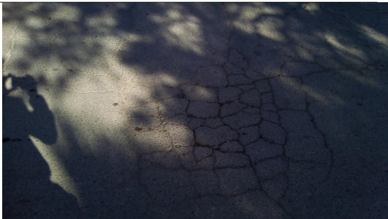
Figure 40: Photo prise de dégradation du type faïençage.
