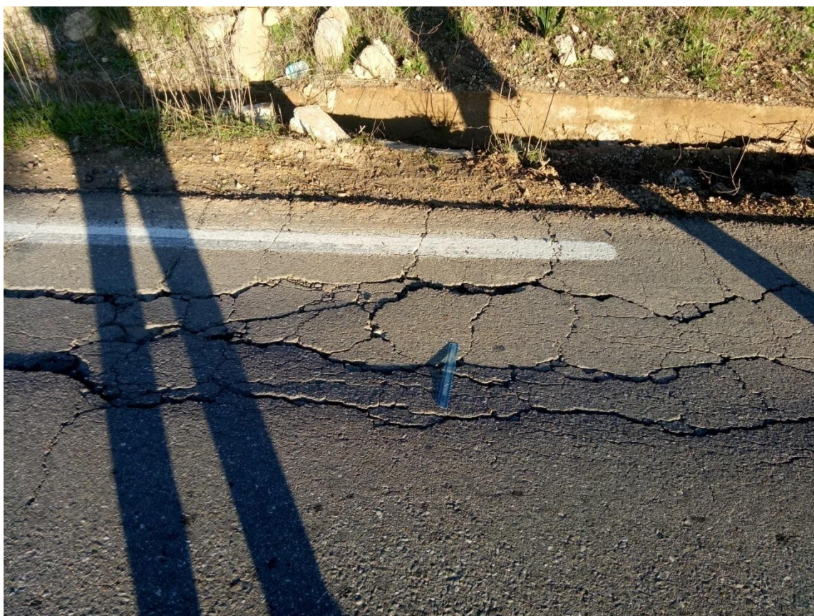
Figure 37: Photo prise du dégradation type affaissement de rive.
